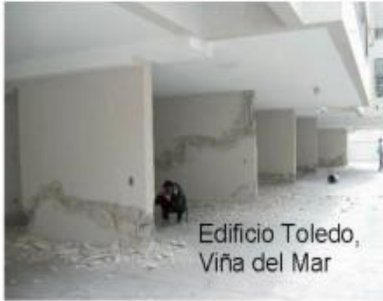
Figura 11. Falla por flexión
