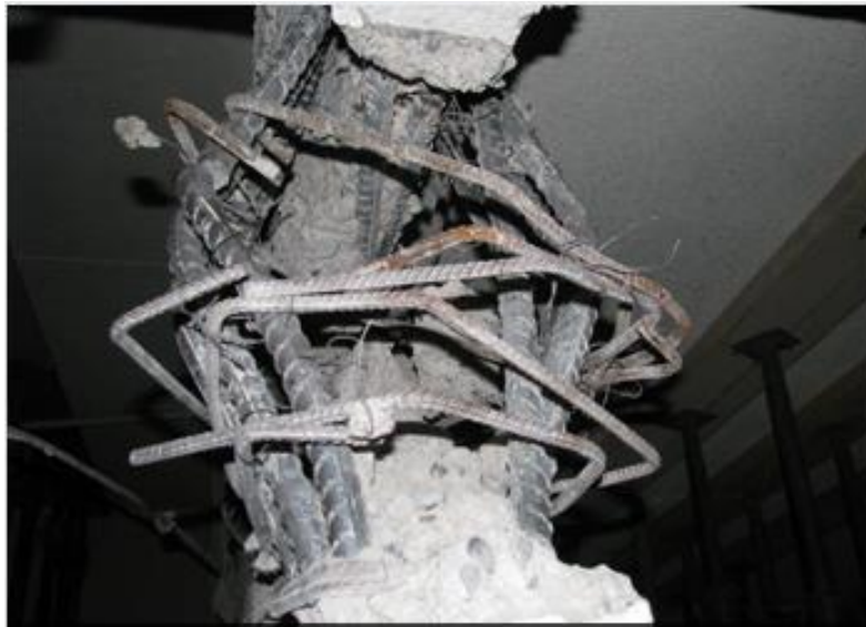
Figura 41. Edificio El Parque. Falta de retorno en la malla horizontal
