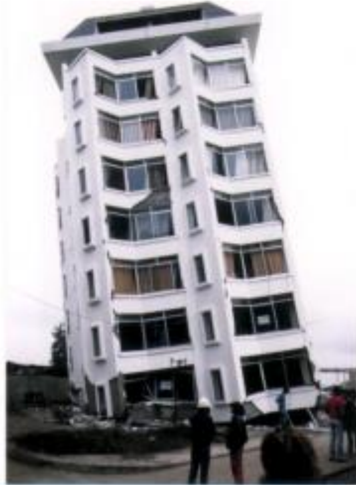
Figura 31. Edificio El Faro después del sismo
