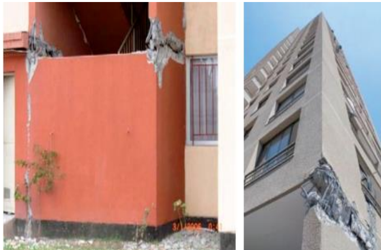
Figura 12. Ausencia de confinamiento en los extremos del muro
