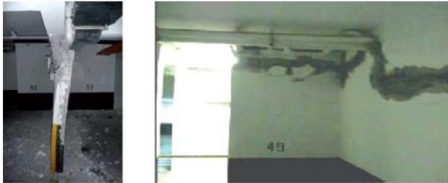
Figura 21. Edificio Esmerald, Santiago, Pandeo de uno de los muros (imagen izquierda) y falla horizontal en el extremo superior (imagen derecha)
