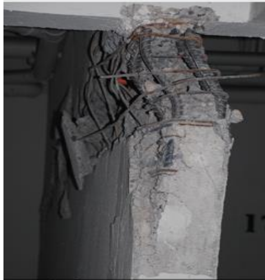
Figura 43. Edificio Sol Oriente. Armaduras abiertas en muro discontinuo
