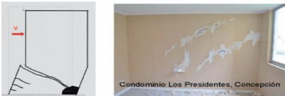
Figura 15. Falla por corte
