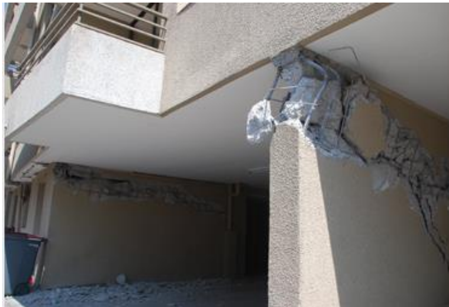
Figura 34. Falla de los estribos
