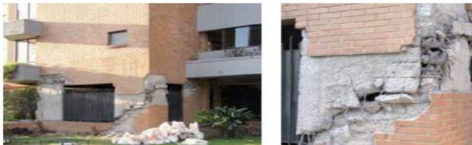
Figura 16. Falla por corte en Viña del Mar, con trituración de los extremos y pandeo del refuerzo vertical no confinado
