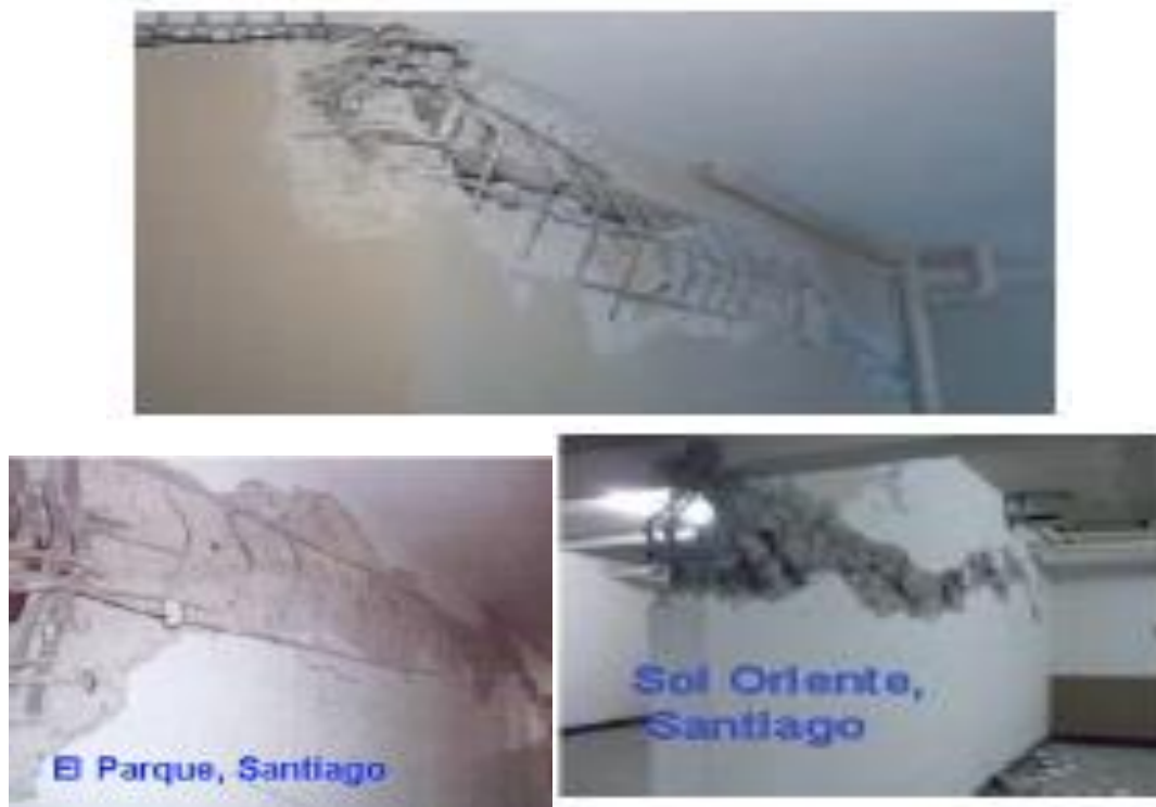
Figura 20. Falla horizontal con pandeo del refuerzo vertical interno
