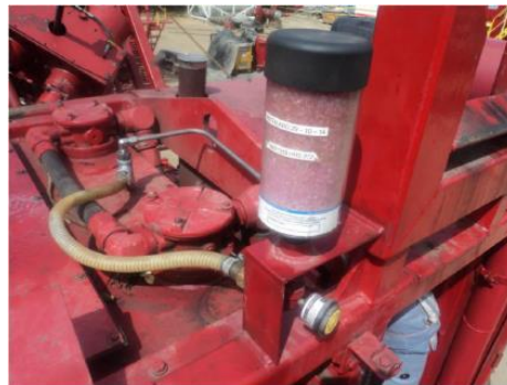
Foto 1. Tanques hidráulicos sellados con respiradero adecuado.
