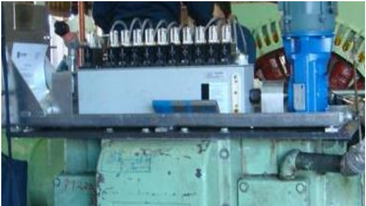
Figura 31. Bomba de lubricación compresor SC2201/02
