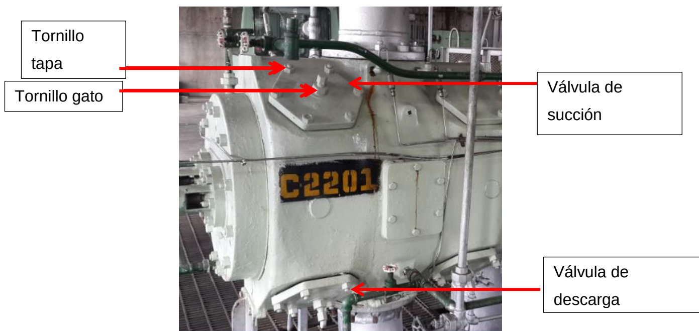
Figura 8. Tapa de válvulas de succión y descarga
