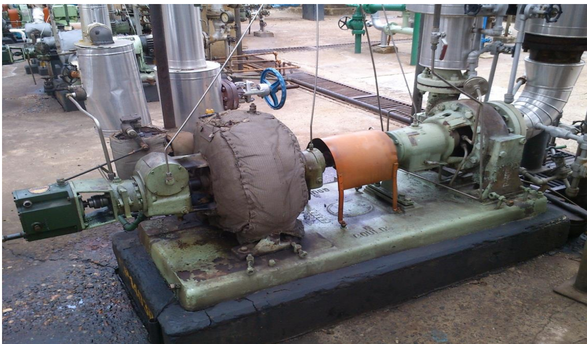
Figura 24. Bombas centrífugas unidad 1400 planta de aromáticos
