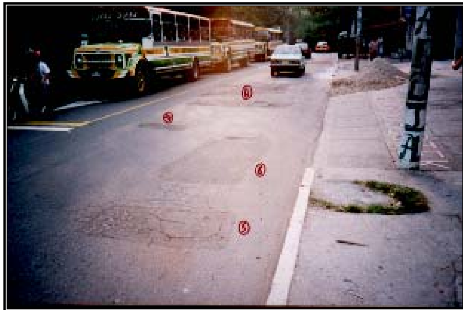
FIGURA 32: Fotografía de la Infraestructura vial urbana (fuente Secretaría de Obras Públicas – Floridablanca). DESESTABILIZACION DE LAS CALZADAS DE LA MALLA VIAL POR EFECTO DE LOS ALTOS NIVELES FREATICOS Y CORRIENTES SUBTERRANEAS.
