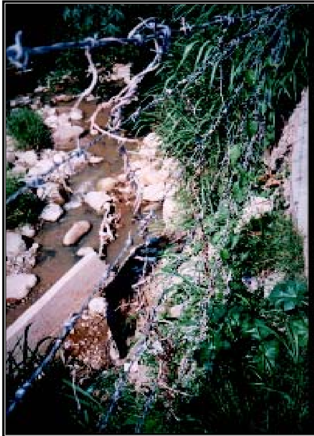
FIGURA 33: Fotografía de la invasión de cauces naturales (Fuente Secretaría de Obras Públicas – Floridablanca).
