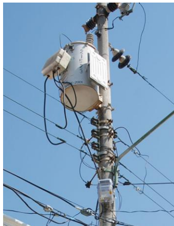
Figura 7. Vista de la ubicación de un medidor y los TC
