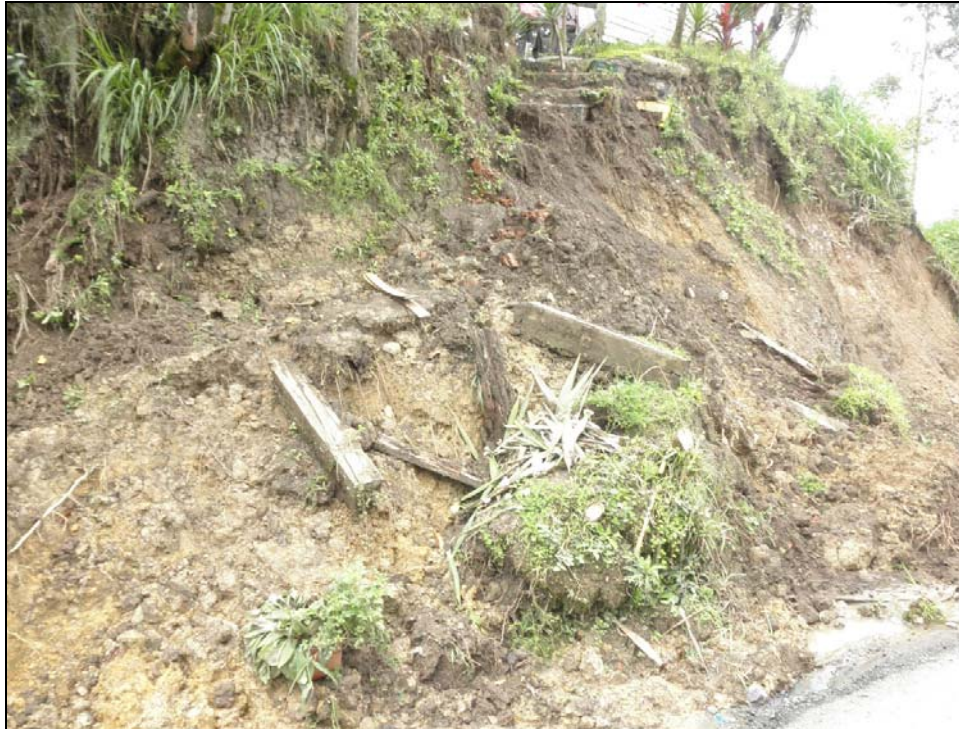
Figura 10. Desprendimiento en la vía Vélez – Chipatá.
