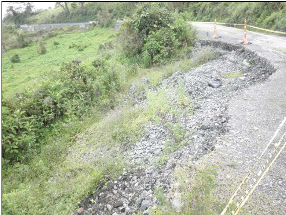
Caída de suelo y detritos en K2+400
