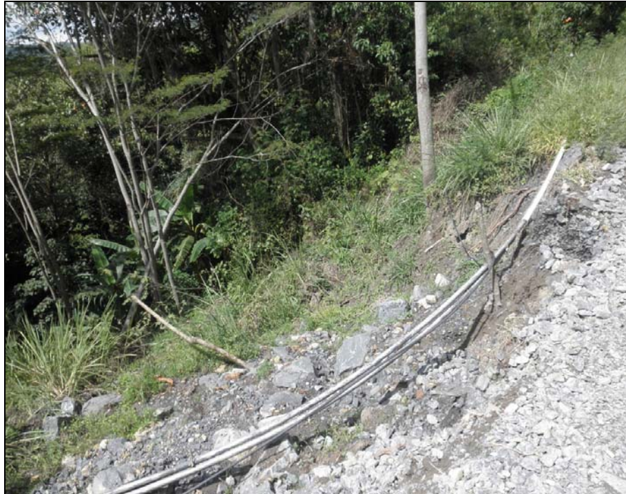
Caída de suelo y detritos en K6+200
