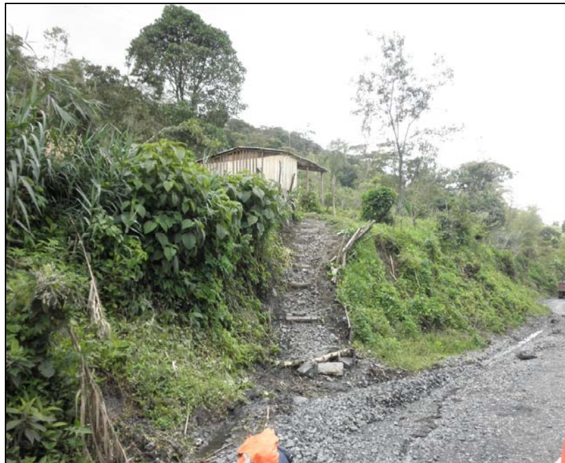
Figura 17. Fenómeno de Reptación en la vía.
