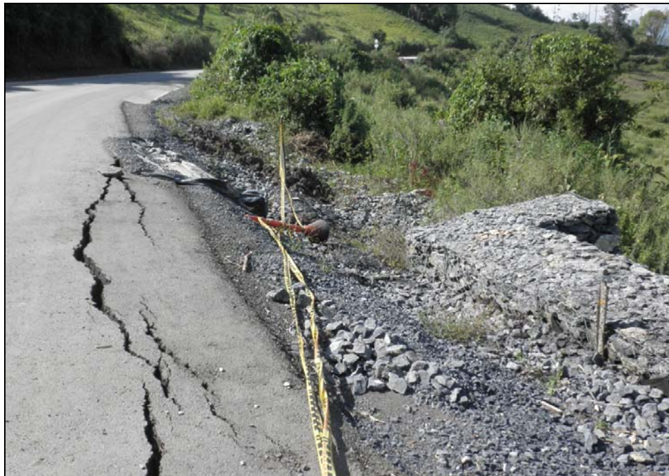
Agrietamiento de la calzada por posible deslizamiento en K2+500
