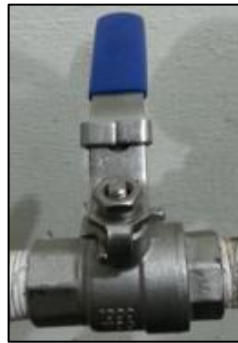
Figura 46. Válvula de bola instalada en la línea hidráulica.
