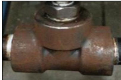
Figura 44. Tee implementada para instalación de manómetro
