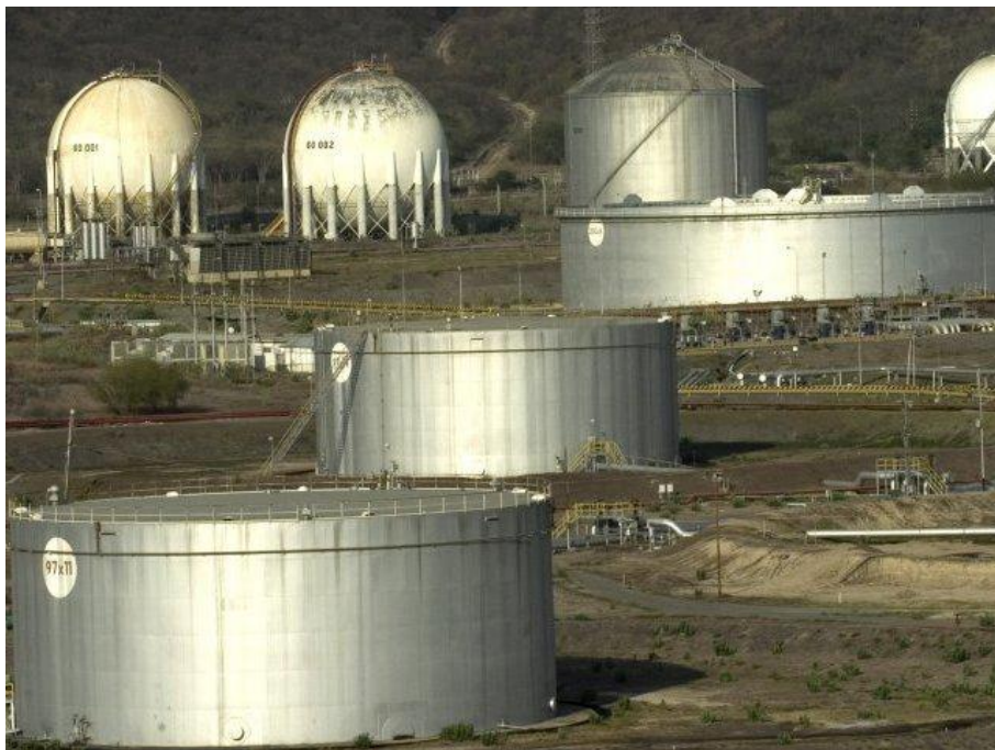
Figura 169. Tanques atmosféricos de almacenamiento
