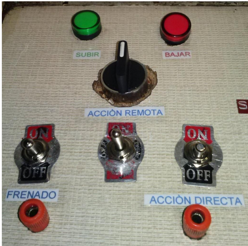
Figura 69: Tablero de control.
