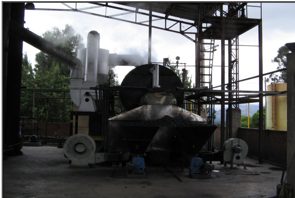
Fotografía N° 2. Caldera para el corrugador
