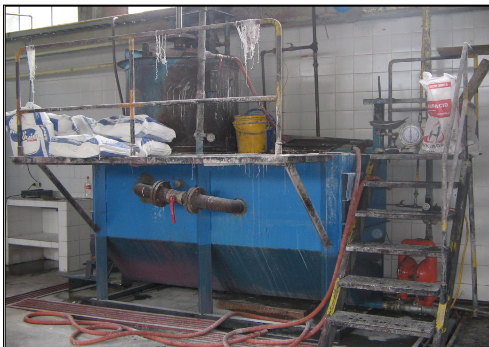
Fotografía N° 4. Tanque secundario de gomas.
