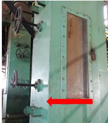
Figura 6. Dámper en la zona superior de la columna
