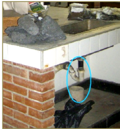
Figura 68. Tubería de desagüe en un mesón de trabajo
