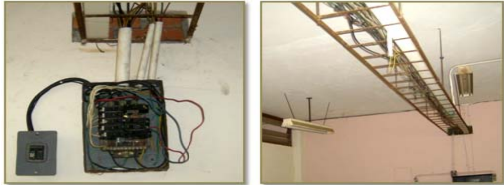
Figura 67. Redes eléctricas del aula 220 Ed. JBV (Año 2007)
