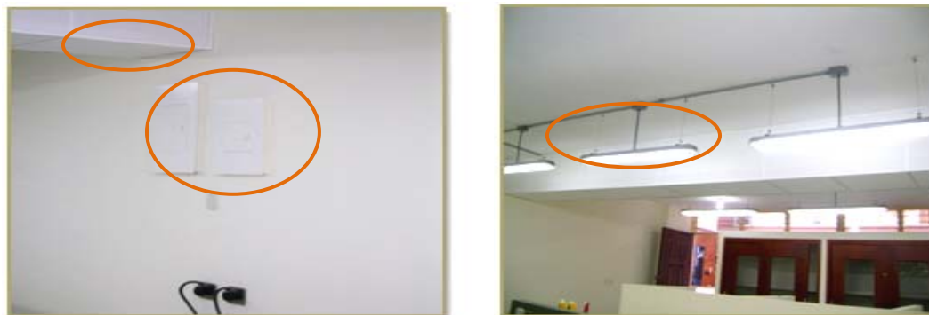
Figura 71. Estado actual de la red eléctrica en el laboratorio
