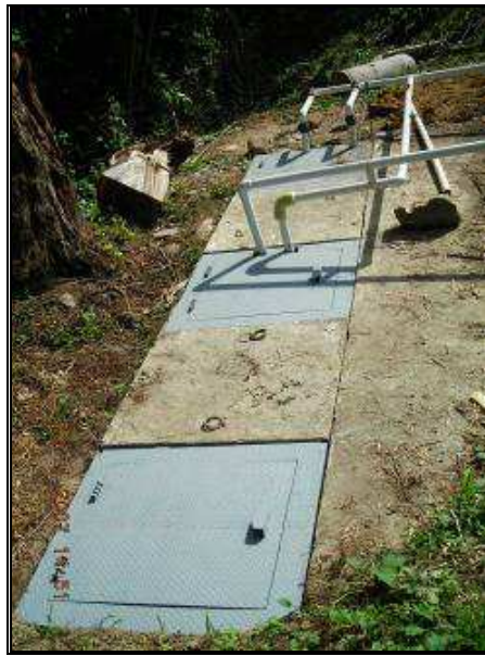
Figura 11. Tanque subterráneo para el bombeo de las aguas residuales provenientes del casino y la lavandería hacia los filtros anaerobios
