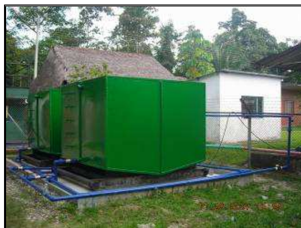
Figura 4. Filtros anaerobios para el tratamiento de las aguas residuales del casino y de la lavandería
