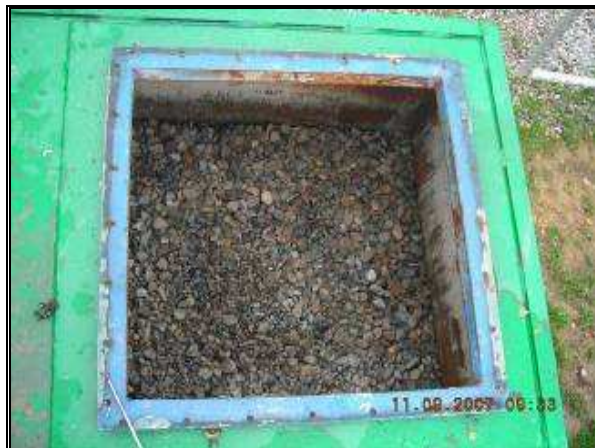
Figura 7. Medio filtrante de los filtros anaerobios
