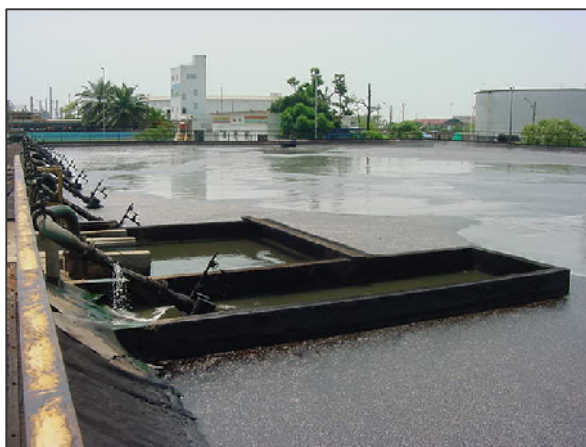
Figura 15. Planta de tratamiento de aguas residuales, tratamiento biológico.
