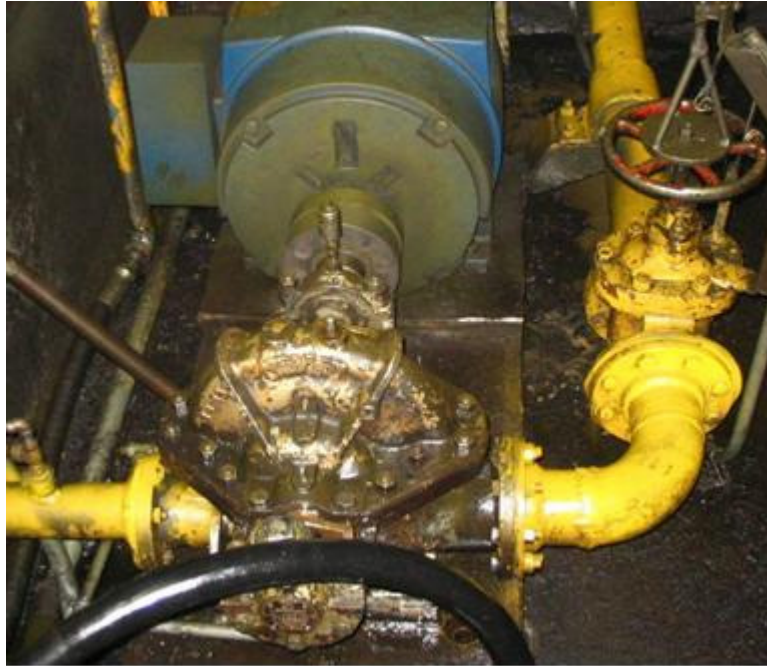
Figura 115. Bomba Centrífuga tipo Carcasa Partida de Sobrecarga
