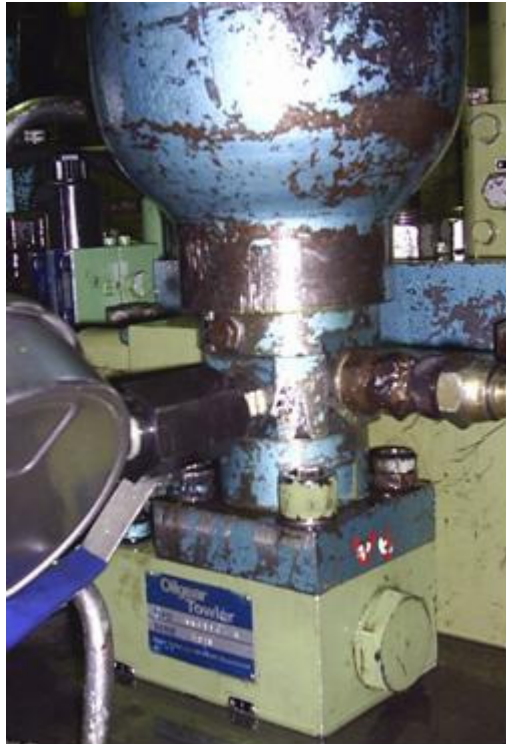
Figura 104. Válvula V6 instalada en Manifold
