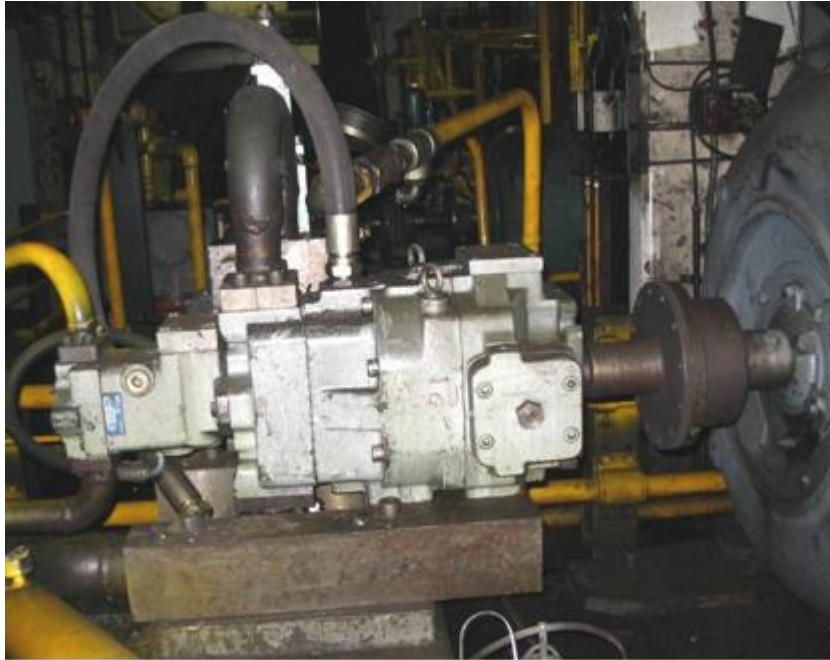
Figura 135. Bomba OILGEAR PVV540 instalada y desacoplada
