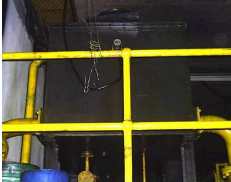
Figura 79. Tanque de Aceite
