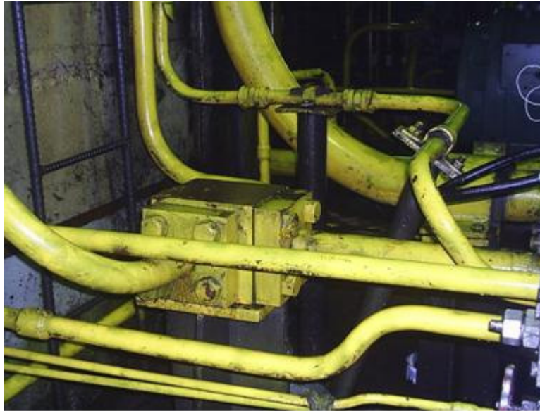
Figura 80. Tuberías del Circuito Hidráulico
