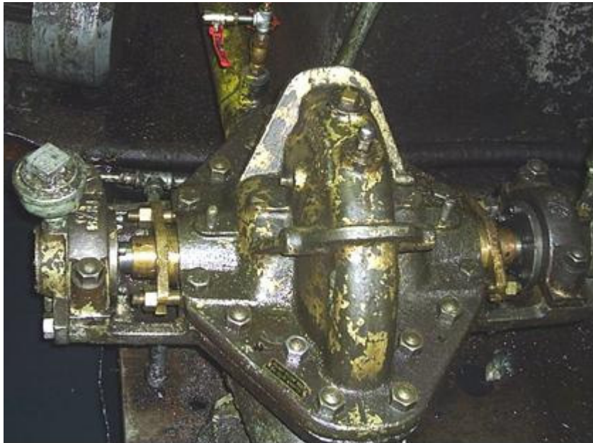
Figura 41. Bomba de Sobrecarga P11
