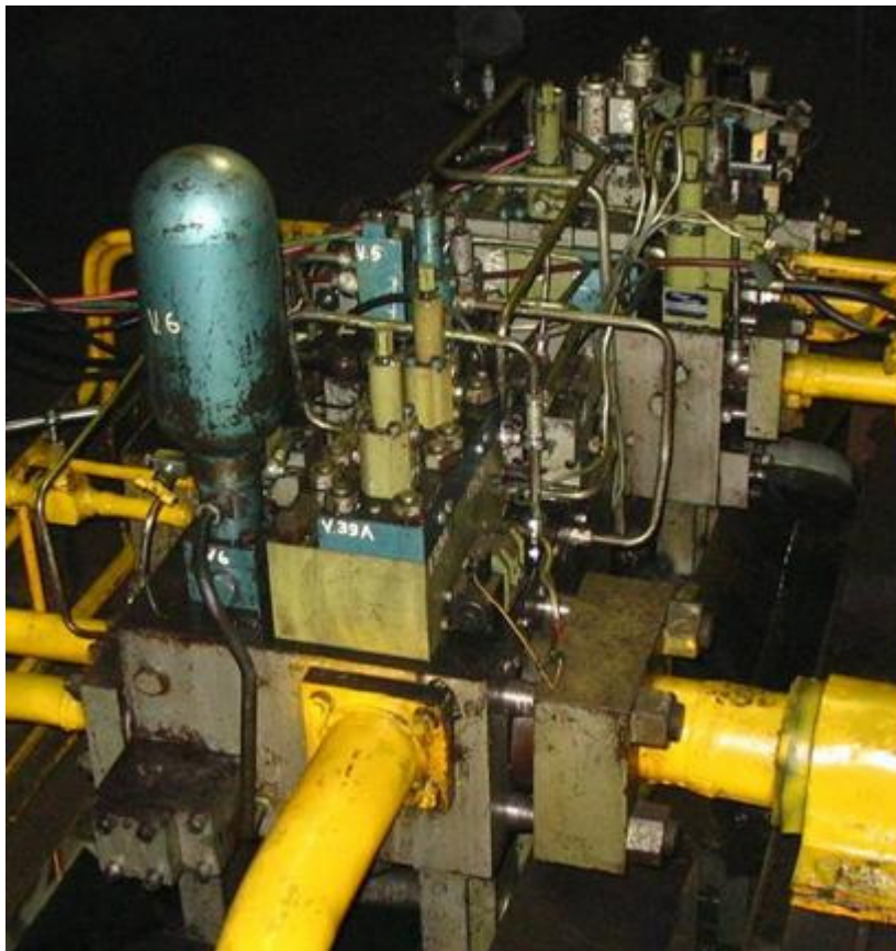
Figura 42. Estación Manifold y Válvulas de Control instaladas
