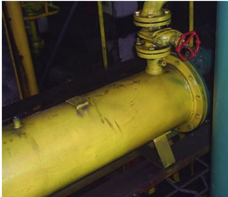
Figura 127. Intercambiador de Calor del Circuito de Potencia
