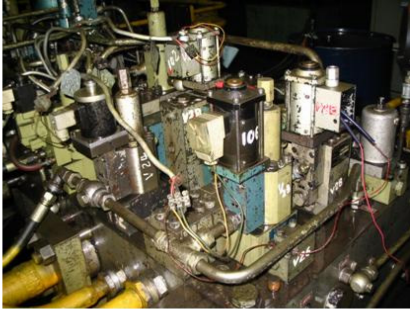
Figura 44. Válvulas Instaladas en Manifold
