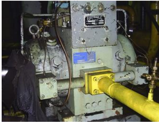
Figura 35. Bomba P2 Instalada en el Circuito Actual
