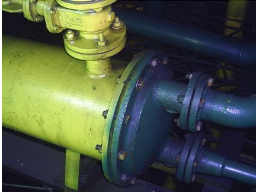
Figura 84. Intercambiador de Calor
