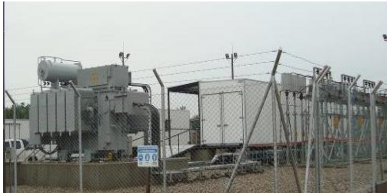
Figura 3. Subestación ISA Caricare
