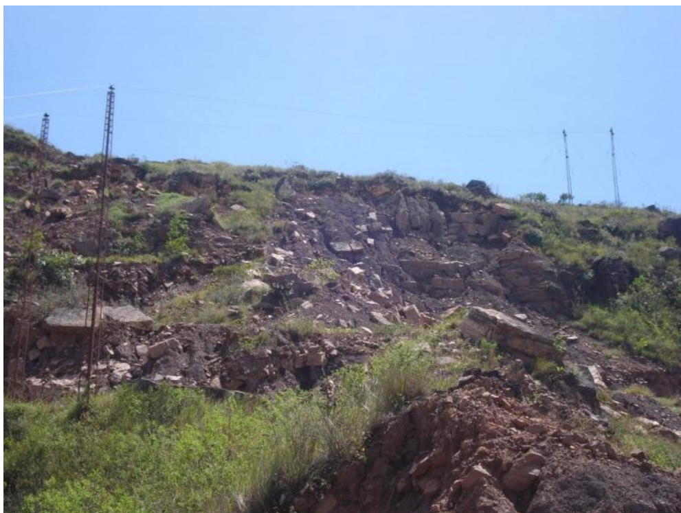
Fotografía 5. Línea de media tensión existente.
