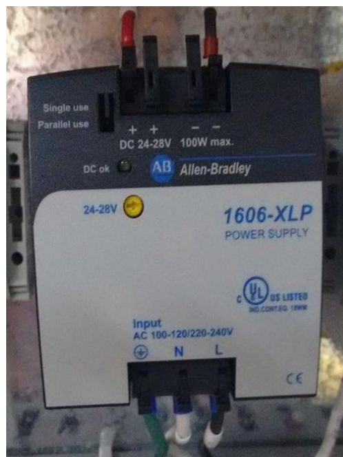
Figura 8. Fuente de alimentación conmutada
