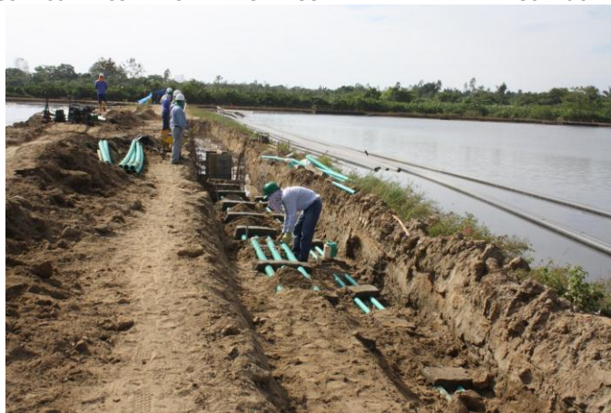
FIGURA 30 BANCO PRINCIPAL A LO LARGO DE LA BERMA ENTRE LAGUNAS 5A Y 5B.
