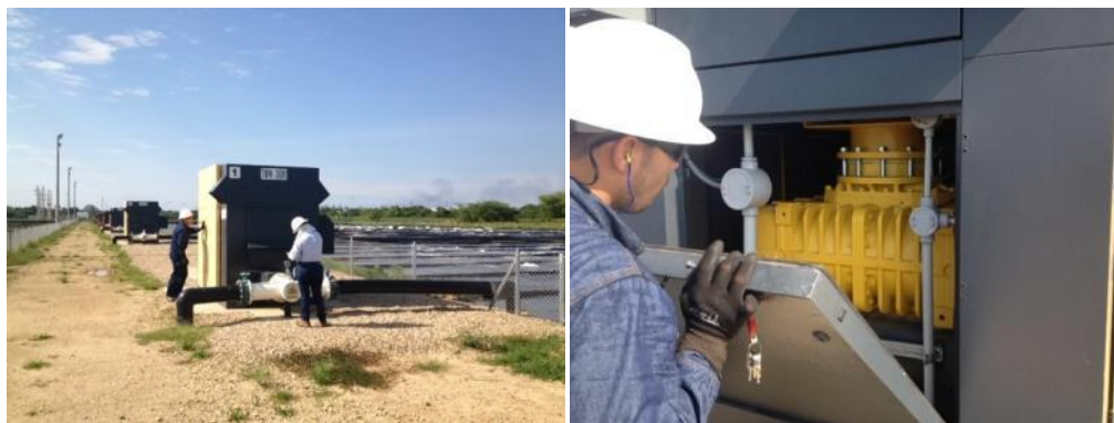
FIGURA 52 INSPECCIÓN DIARIA DE SOPLADORES.
