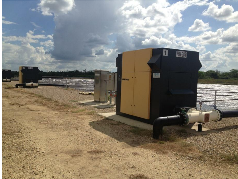
FIGURA 44 SOPLADORES CON CABINA DE INSONORIZACIÓN TERMINADA.
