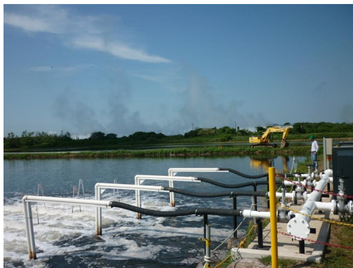
FIGURA 6 VISTA GENERAL DEL PRIMER PILOTO DE AIREACIÓN.
