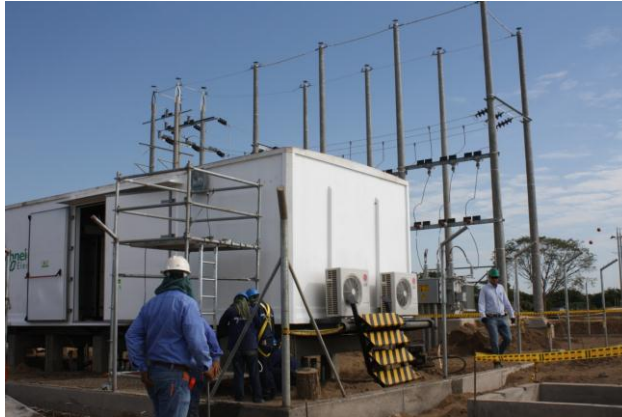
FIGURE 32 CENTRO DE CONTROL DE MOTORES CCM.
