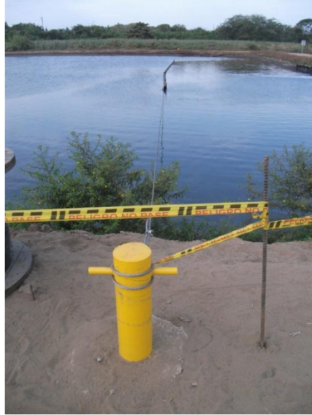
FIGURA 50 DETALLE DE ANCLAJE PARA PANTALLA DEFLECTORA. AL FONDO EN LA IMAGEN SE OBSERVA EL BAFLE EN POSICIÓN.
