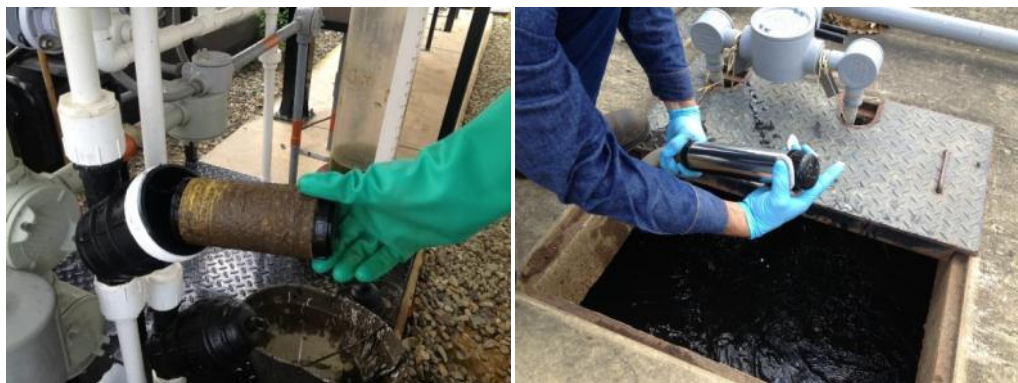
FIGURA 51 LABORES DE LIMPIEZA DE LÍNEAS DE DOSIFICACIÓN Y DE SONDAS ANALÍTICAS (DERECHA. SONDA DE OXIGENO DISUELTO).
