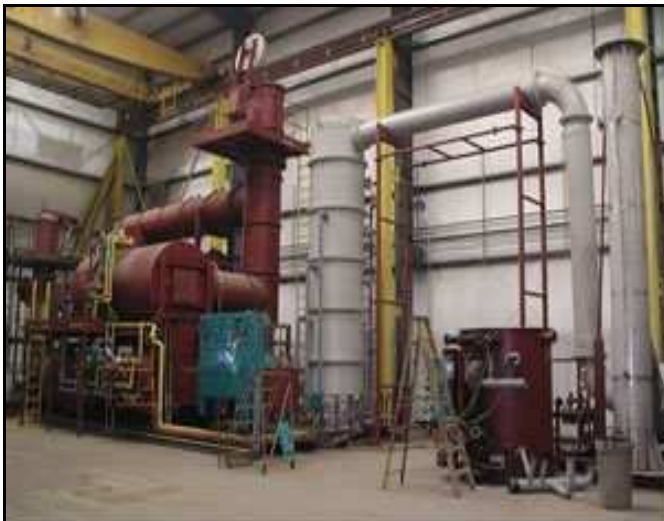
Fotografía 20. Incinerador Penram 550 lb/hr
