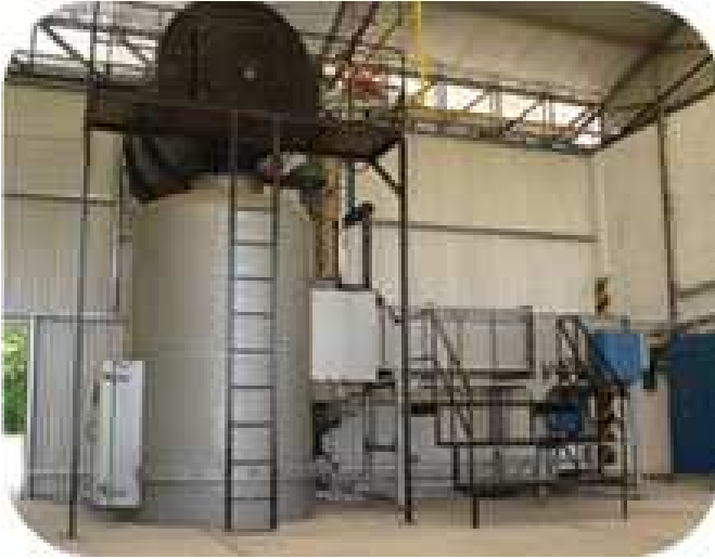
Fotografía 16. Incinerador línea horizontal Caltec
