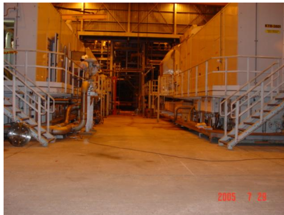
Figura 11. Tren de Reinyección, unidad MP y HP.
