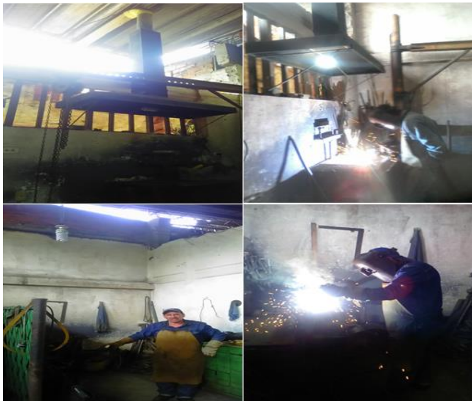
Figura 42. Condiciones actuales del espiroducto de humos de soldadura en Talleres Terminal.
