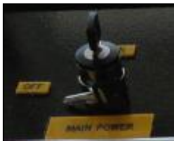
Figura 23. Interruptor principal. Fuente: Autores.
