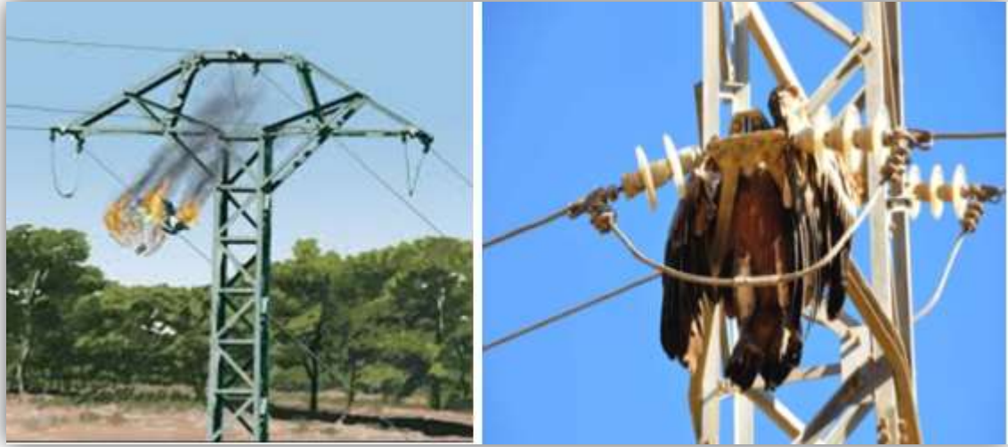
Figura 12. Electrocción de aves en postes de distribución de energía.
