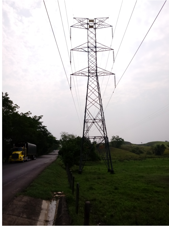
Figura 10. Torre 230 Kva Magalena Medio Colombiano
