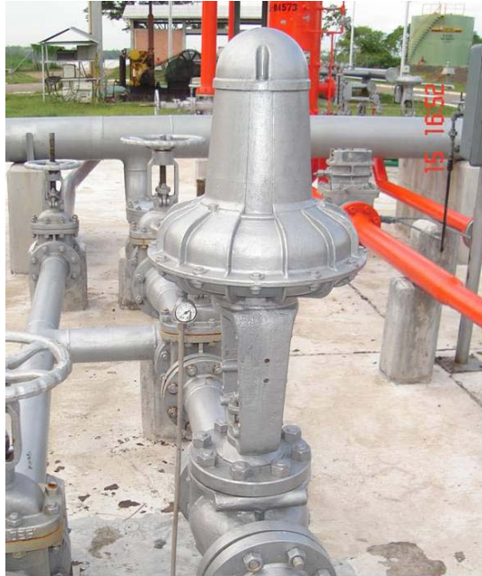
Figura 43. Válvula de Control Neumática
