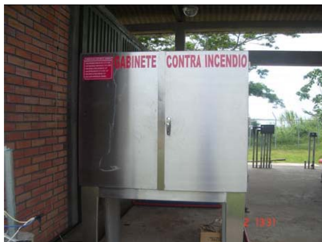
Figura 34. Tanque de Contraincendios K 4-03
