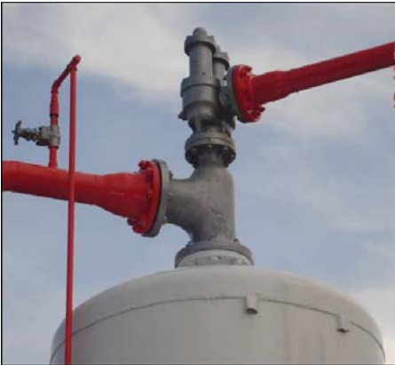
Figura 44. Válvulas de Seguridad de Sobrepresión – PSV
