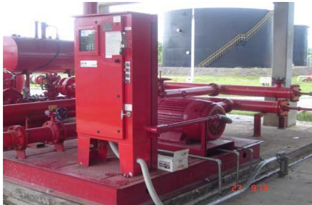
Figura 35. Sistema Contraincendios Bomba Eléctrica
