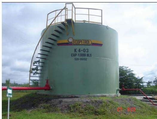
Figura 33. Tanque de Contraincendios K 4-03
