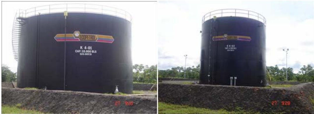
Figura 29. Tanques de Almacenamiento K 4-01 y K 4-02
