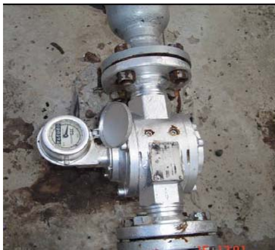
Figura 28. Medidor de Flujo - FQI
