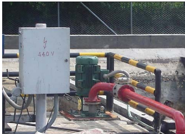
Figura 38. Bomba de Trasiego Sistema Contraincendio
