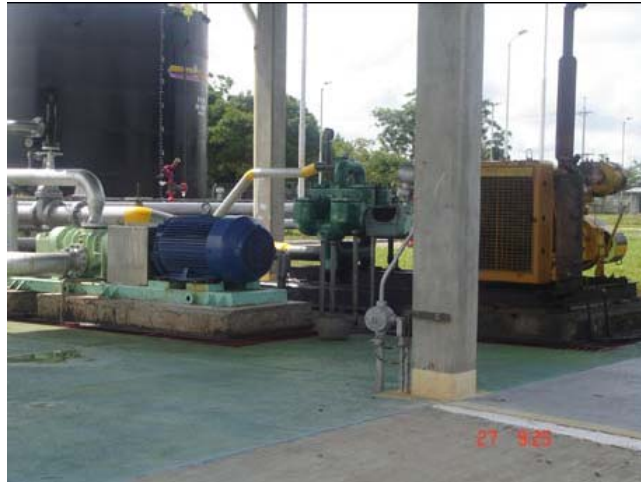
Figura 32. Sistema de Bombeo
