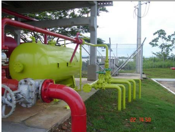
Figura 37. Tanque de Almacenamiento de Químico
