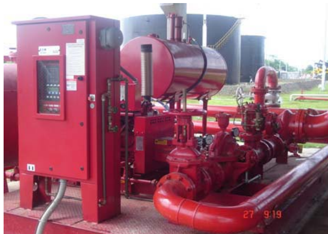
Figura 36. Sistema Contraincendio del Motor Diesel
