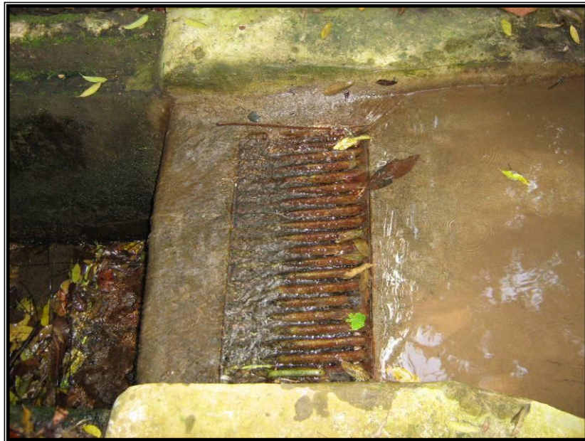
Figura 2. Bocatoma Quebrada La Guaba
