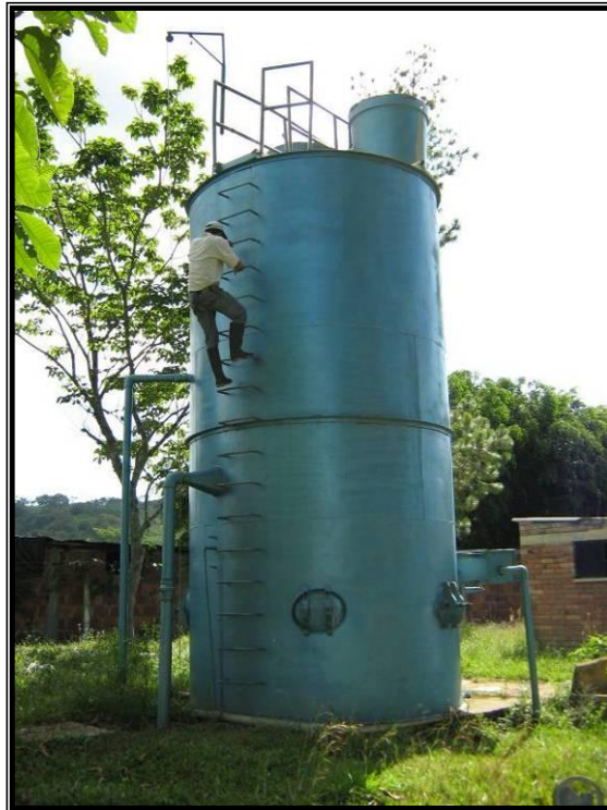
Figura 8. Planta de Tratamiento compacta.
