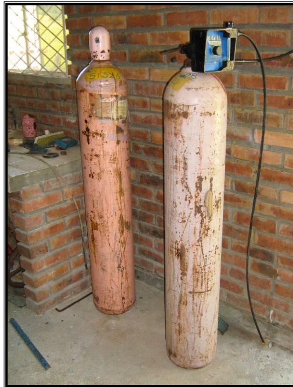
Figura 10. Tanques de Cloro
