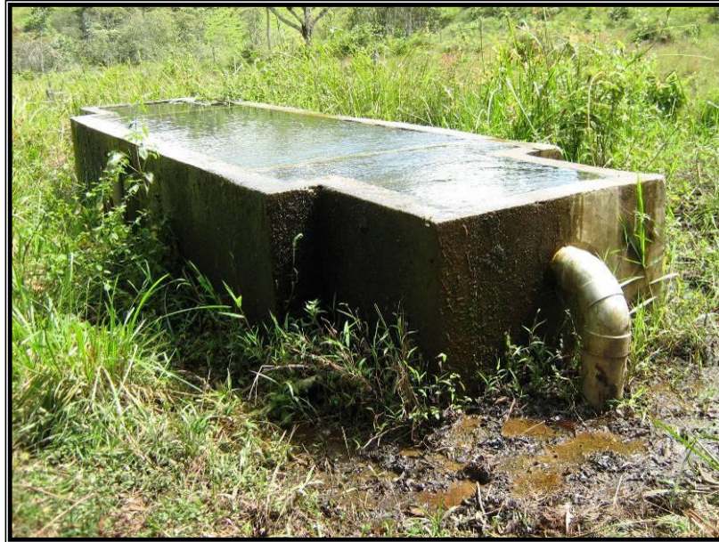
Figura 7. Detalle Desarenador Quebrada la Chorrera
