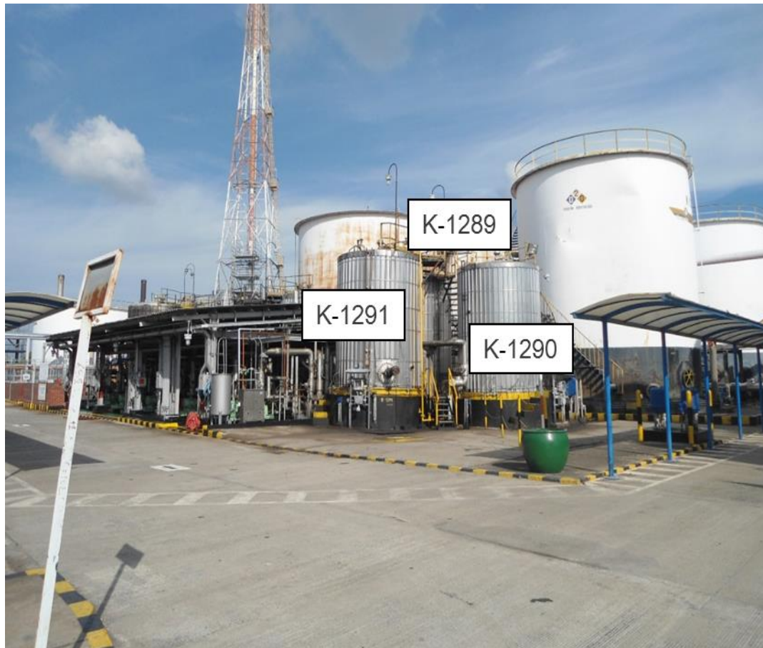
Figura 33. Tanques de almacenamiento K-1289, K-1290 y K-1291 del Departamento de Parafinas y Fenol.
