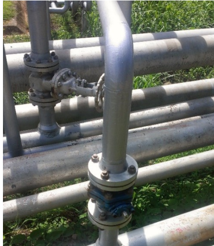
Figura 57. Colector de gas del punto Wilches 3.
