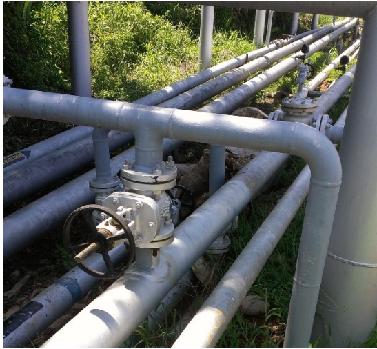
Figura 60. Colector de gas del punto Wilches 6.
