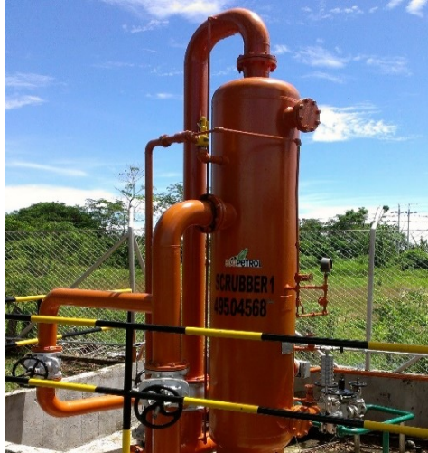
Figura 52. Scrubber de la Estación Auxiliar.
