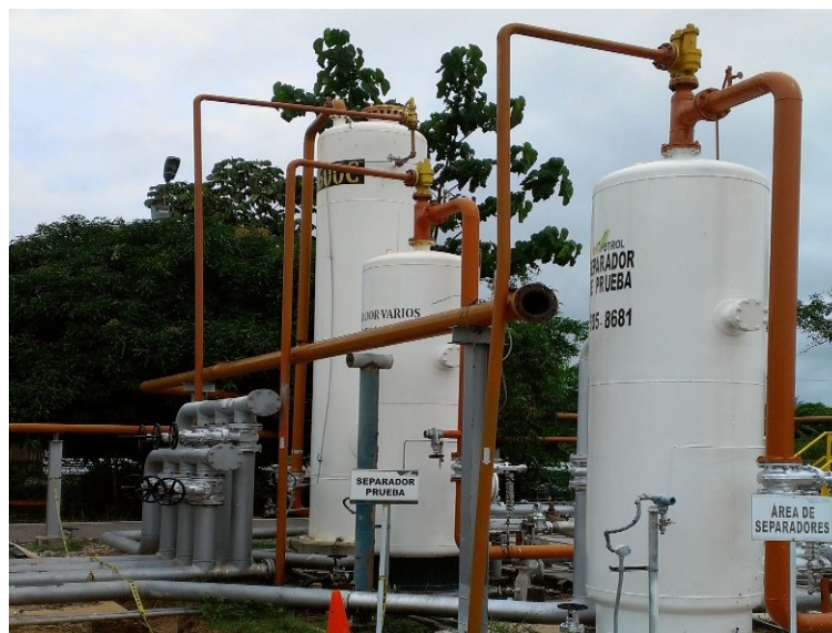
Figura 38. Zona de separadores Estación Isla 6
