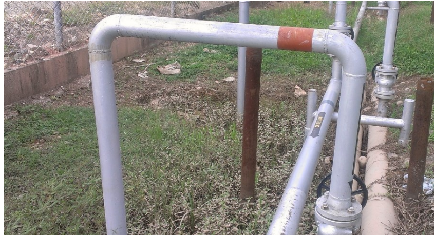
Figura 45. Colector de gas del punto Cantagallo 2.
