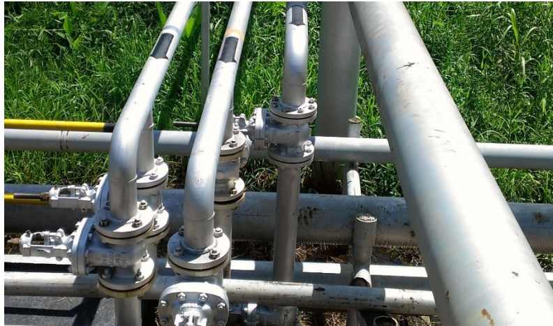
Figura 61. Colector de gas del punto Wilches 7.
