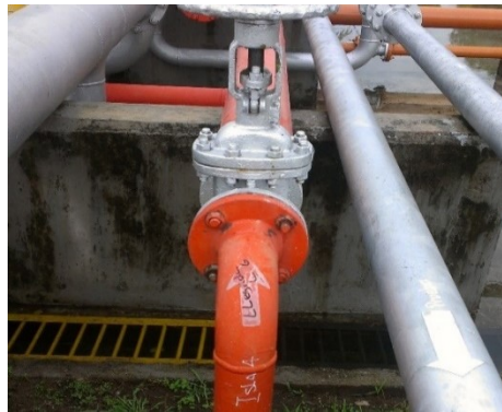
Figura 53. Colector de gas del punto Isla 4-1.
