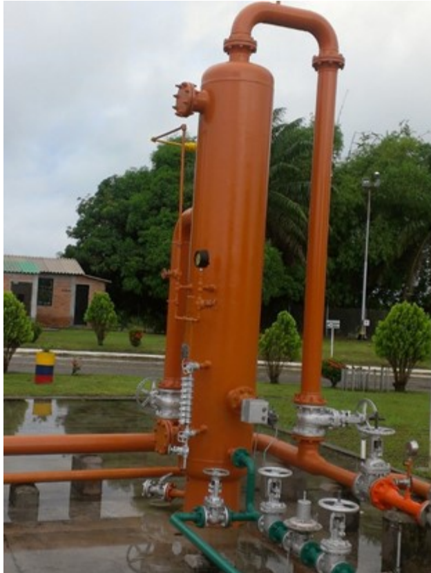
Figura 36. Scrubber a compresora Estación Isla 4.
