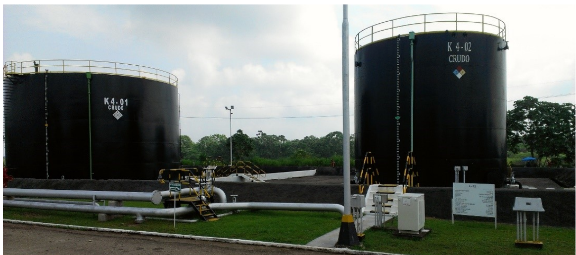
Figura 33. Tanques de almacenamiento Estación Isla 4.
