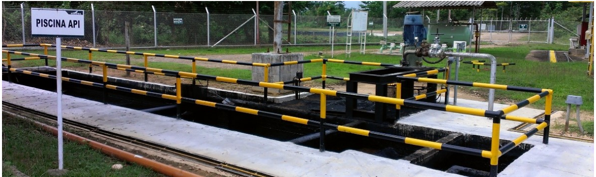
Figura 30. Piscina API Estación Auxiliar.
