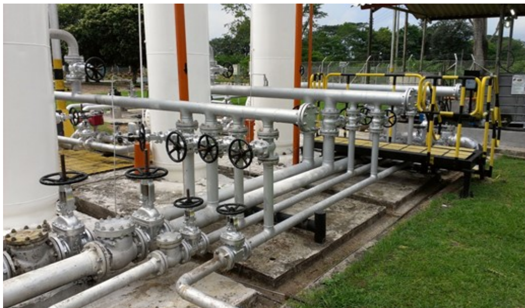
Figura 26. Múltiple de entrada Estación Auxiliar.
