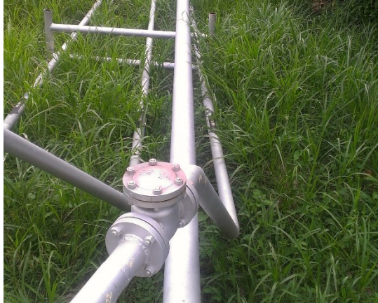
Figura 47. Colector de gas del punto Cantagallo 4.
