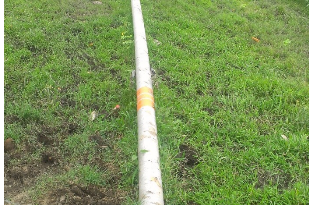
Figura 51. Colector de gas del punto Cantagallo 8.
