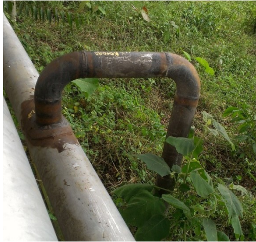
Figura 62. Colector de gas del punto Wilches 8.
