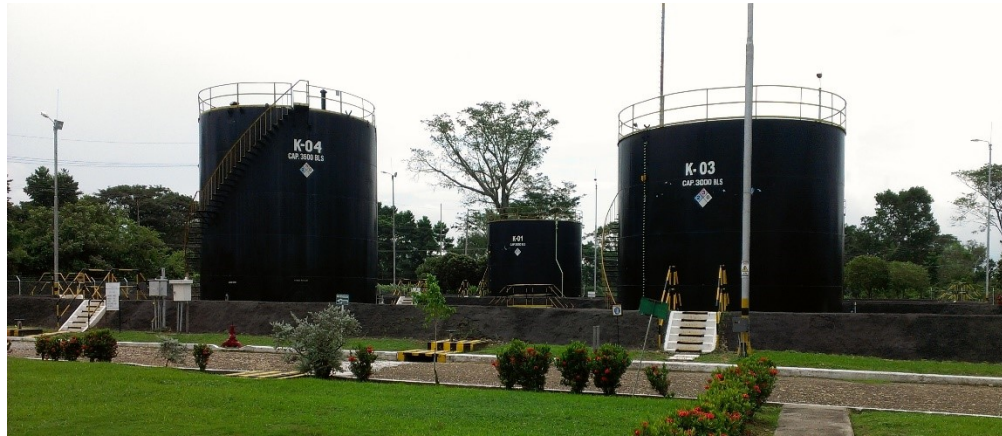
Figura 28. Tanques de almacenamiento Estación Auxiliar.
