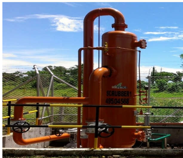
Figura 24. Scrubber a compresora Estación Auxiliar
