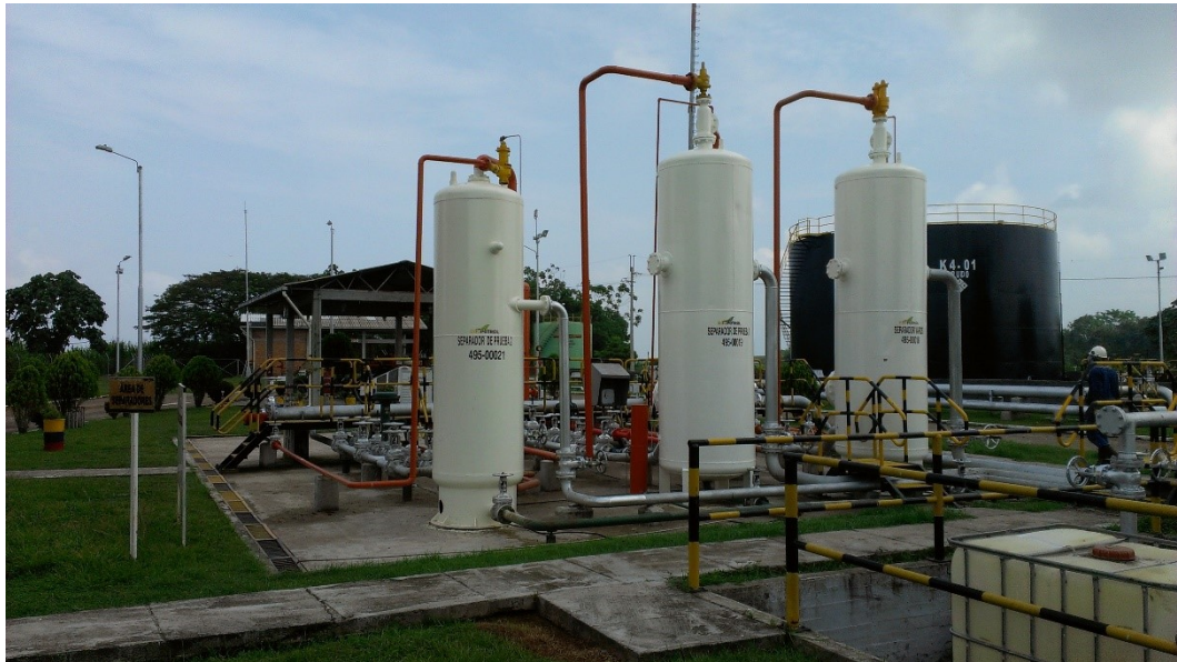
Figura 32. Zona de separadores Estación Isla 4.
