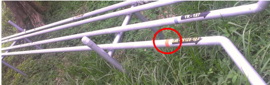
Figura 46. Colector de gas del punto Cantagallo 3.
