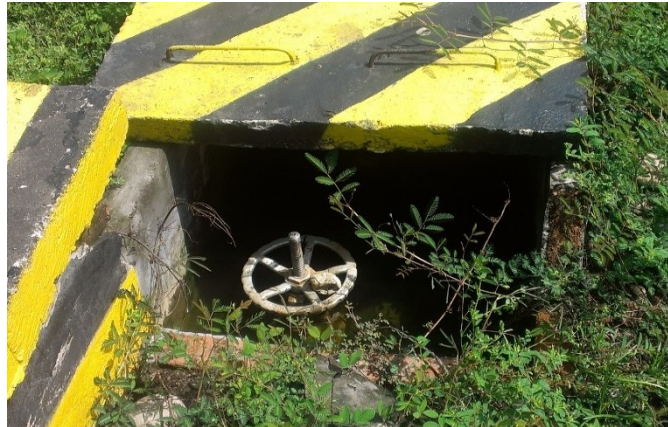
Figura 56. Colector de gas del punto Wilches 2.
