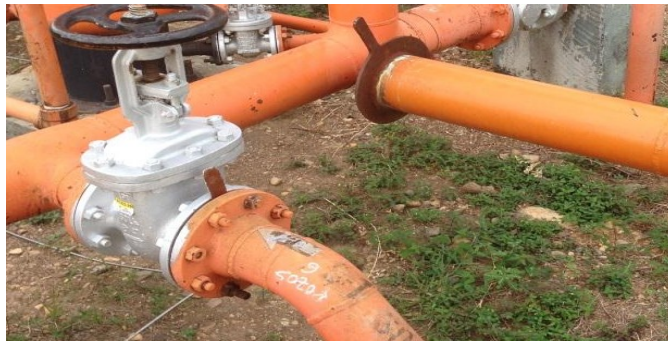
Figura 55. Colector de gas del punto Wilches 1.
