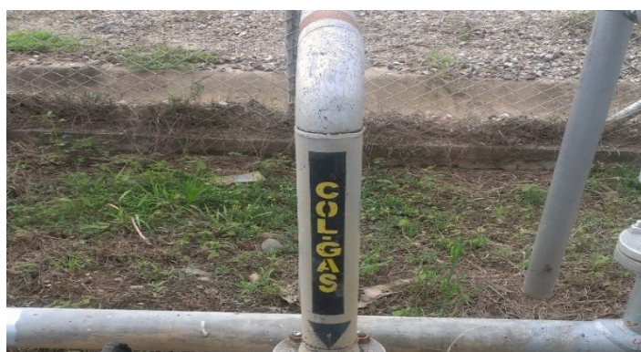
Figura 44. Colector de gas del punto Cantagallo 1.
