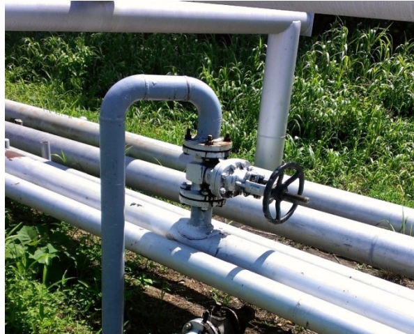
Figura 59. Colector de gas del punto Wilches 5.
