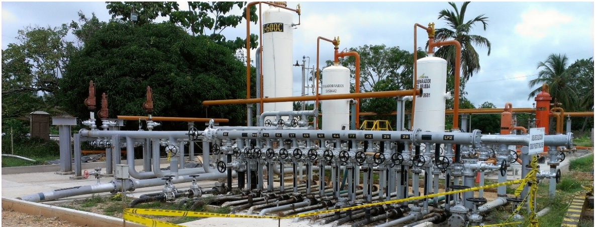
Figura 37. Múltiple de entrada Estación Isla 6.
