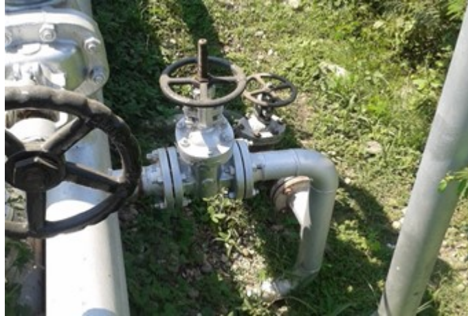
Figura 50. Colector de gas del punto Cantagallo 7.
