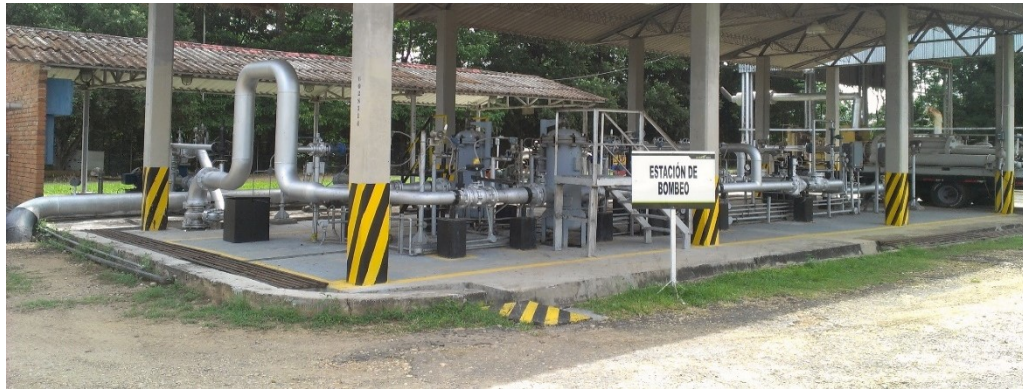
Figura 41. Estación de bombeo Isla 6
