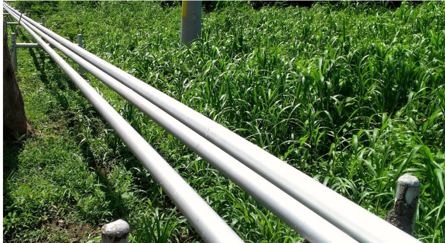
Figura 58. Colector de gas del punto Wilches 4.
