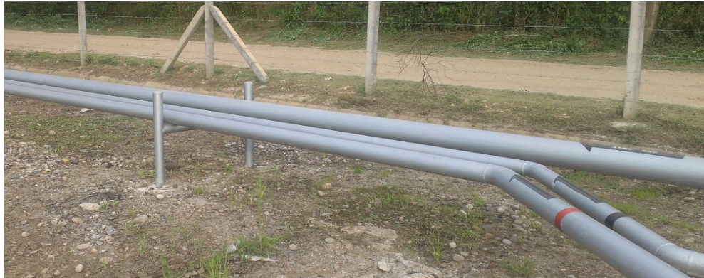
Figura 48. Colector de gas del punto Cantagallo 5.
