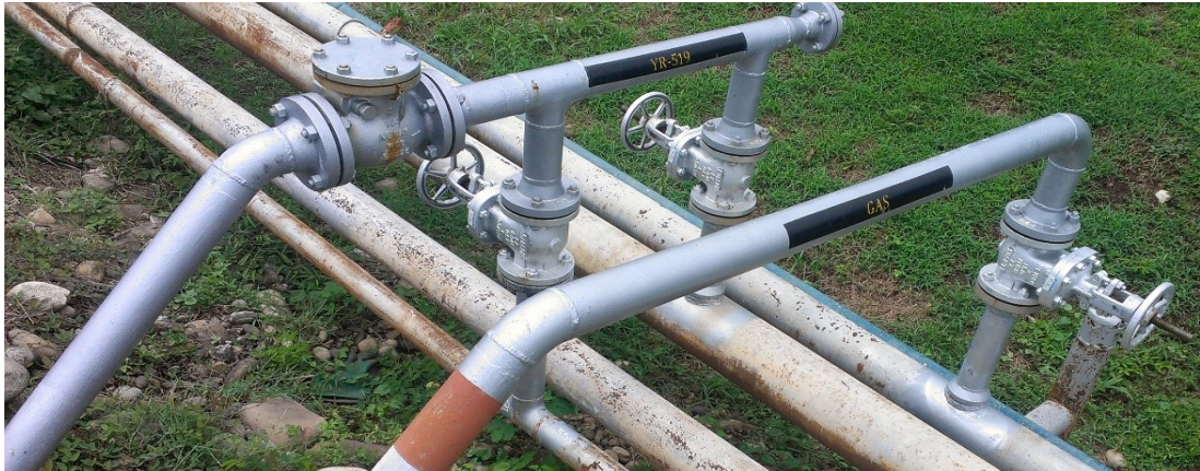
Figura 54. Colector de gas del punto Isla 4-2.
