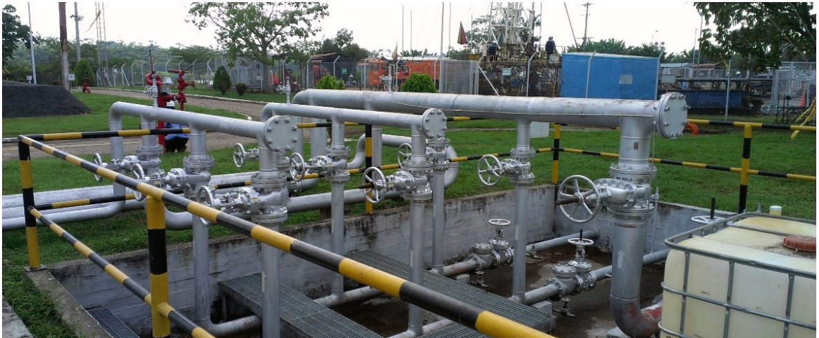
Figura 31. Múltiple de entrada Estación Isla 4.
