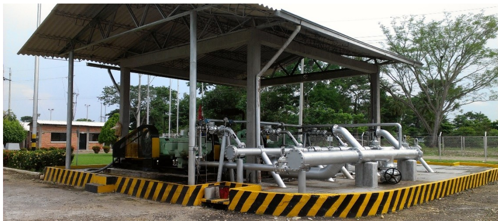
Figura 29. Bombas de despacho Estación Auxiliar.
