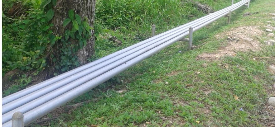
Figura 49. Colector de gas del punto Cantagallo 6.
