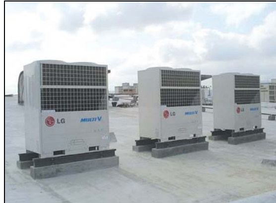
Fig 13. Unidades exteriores Sistema Refrigerante Variable Edificio Administración II
