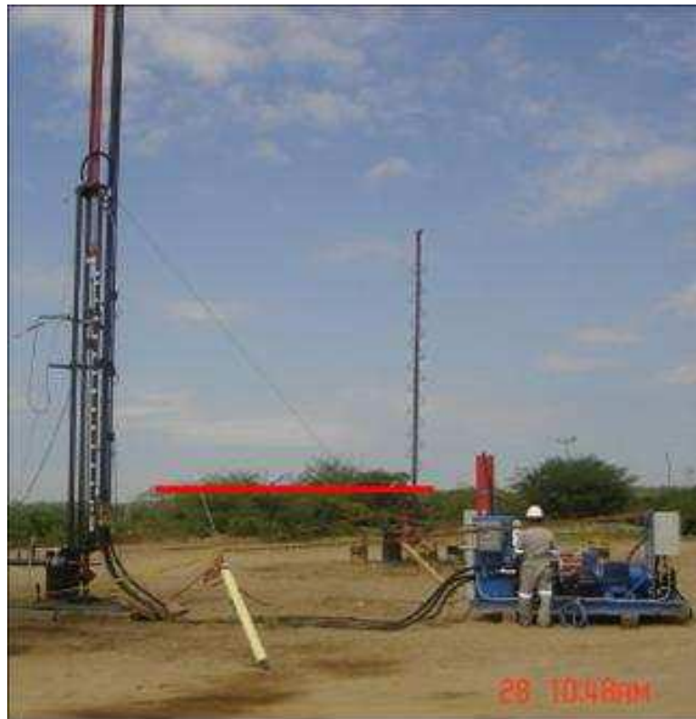
Figura 13. Equipo superficial Unidad VSH2. 19
