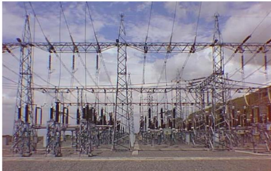
Figura 2 Subestación de Potencia
