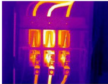
Figura 11. Imagen de termografía de un interruptor
