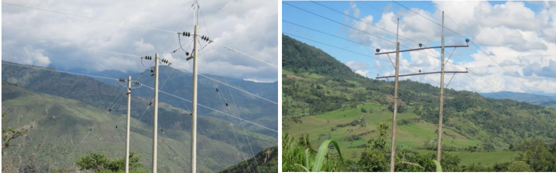
Figura 5 Imágenes estructuras de 115 KV
