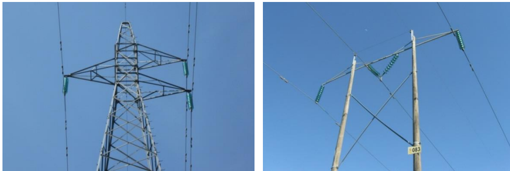
Figura 4. Imágenes estructuras de 115 KV
