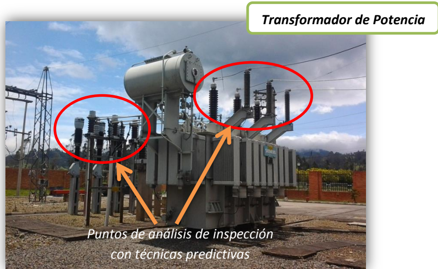
Figura 29. Transformador de potencia
