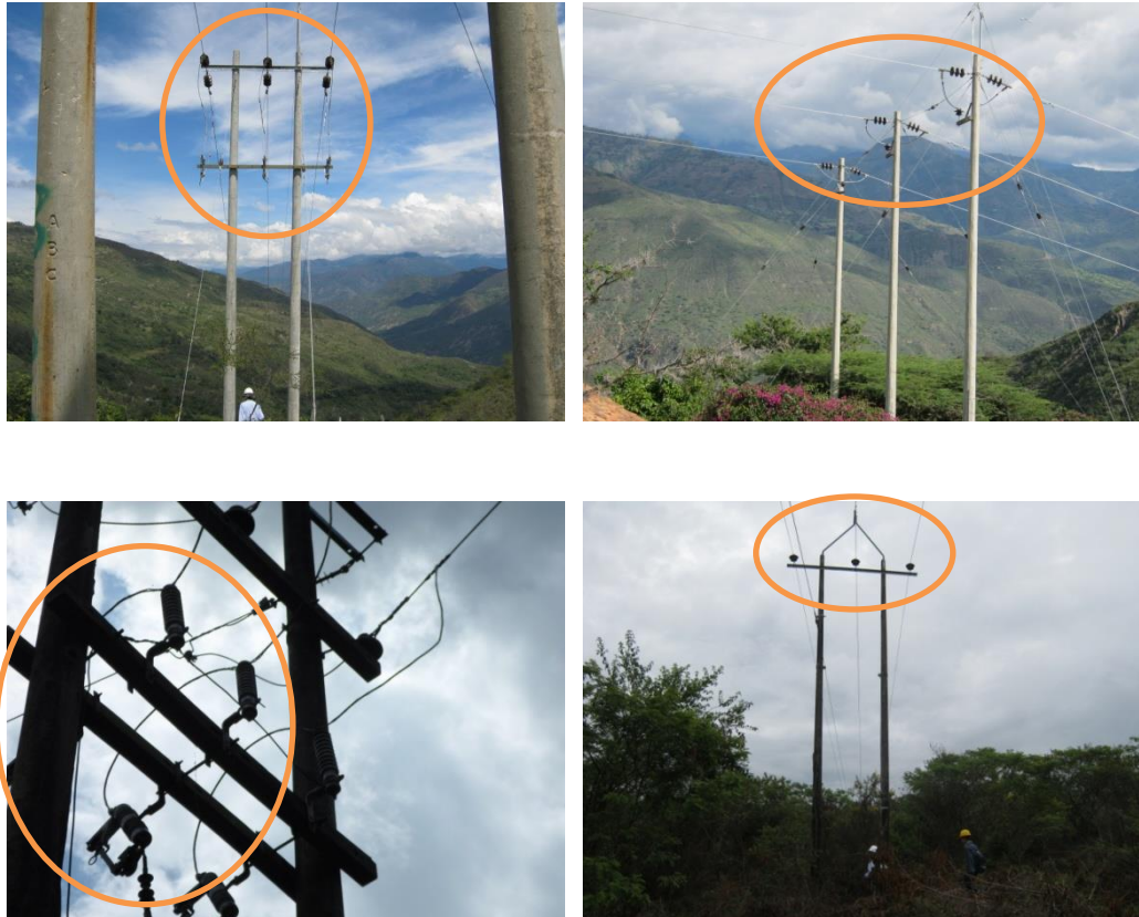
Figura 35. Estructuras para líneas de sub-transmisión de 34,5 KV
