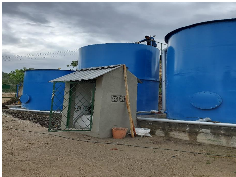
Figura 5. PTAR Villa del Sol.
