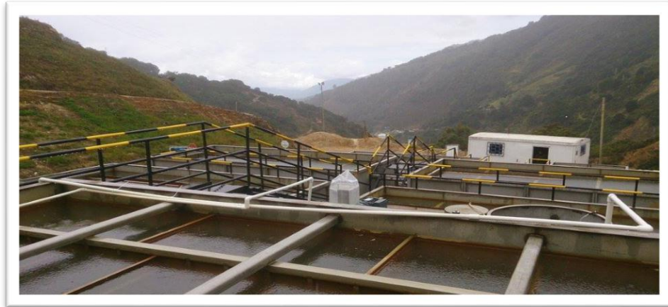
Figura 6 Sistema activo de neutralización industrial de drenaje ácido de mina.
