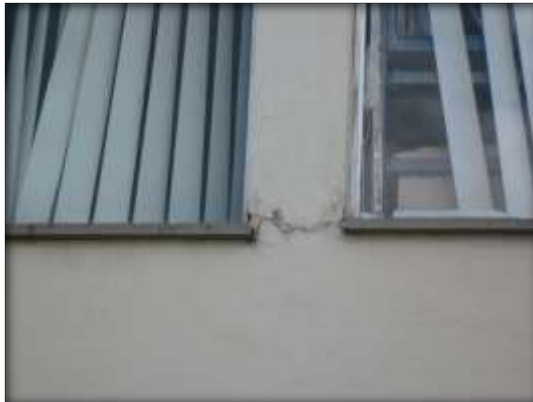
Figura 7. Fisuras en muros piso 2.
