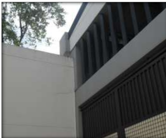
Figura 5. . Fisuras en muros piso 2.
