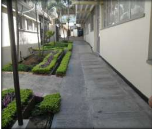
Figura 3. . Estado de muros piso 1.
