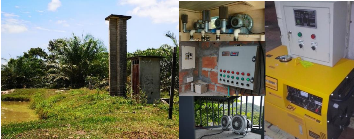
Caseta y tablero de control
