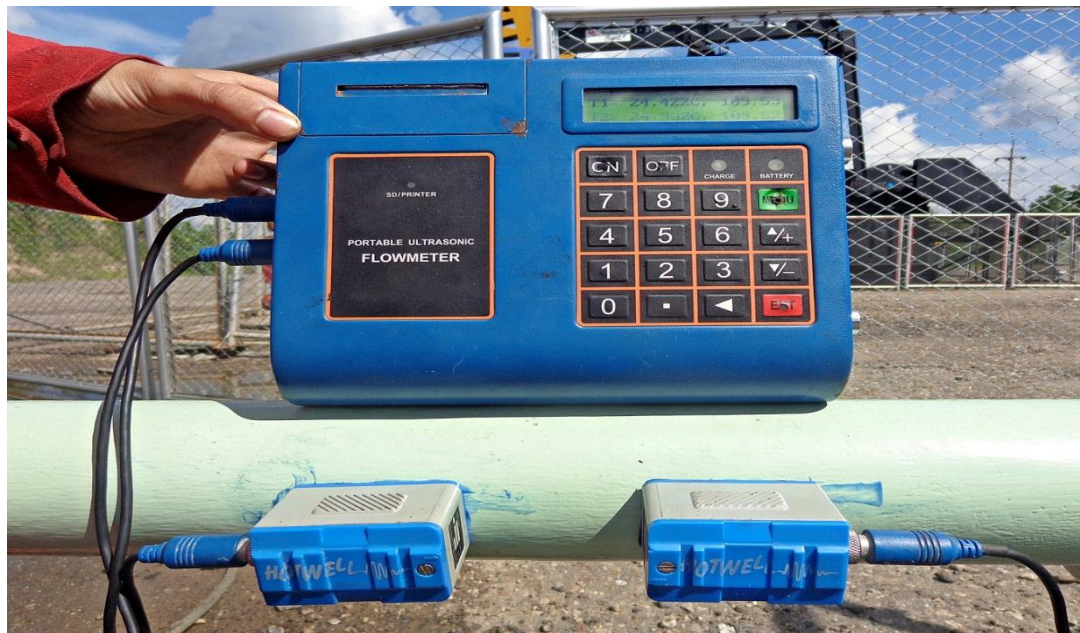
Figura 38. Montaje medidor de caudal Flowmeter HOTWELL COLOMBIA
