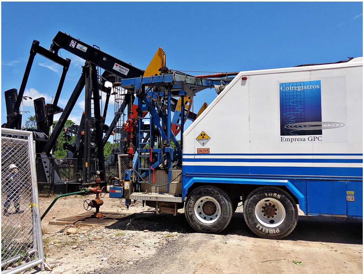
Figura 28. Alineación torre, unidad de registro y el cabezal del pozo inyector.
