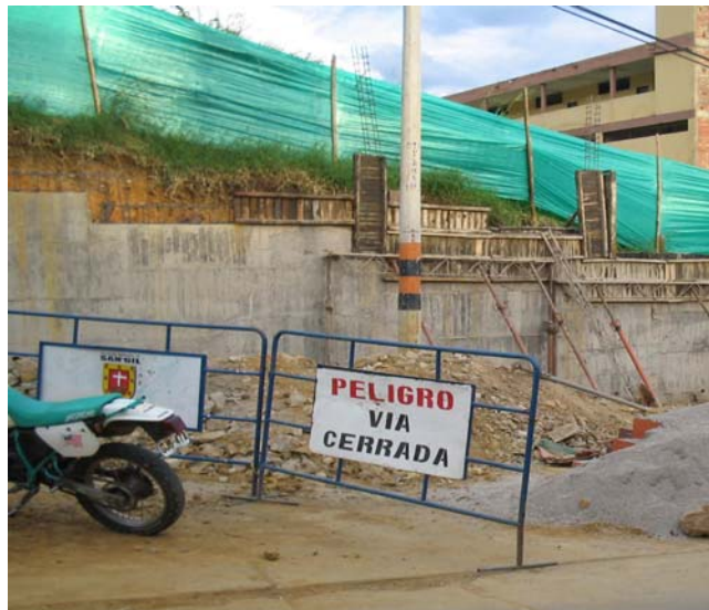
Fotografía 47. Estado antes de retirar escombros
