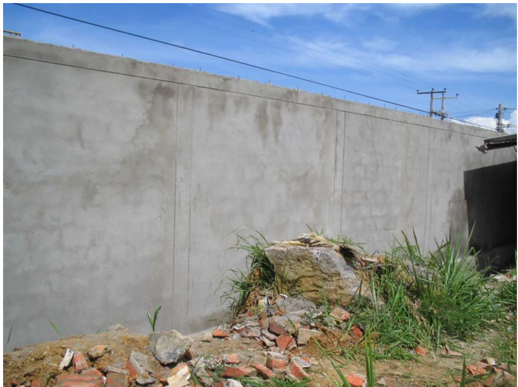
Fotografía 49. Friso y dilataciones por la carrera 6ta.
