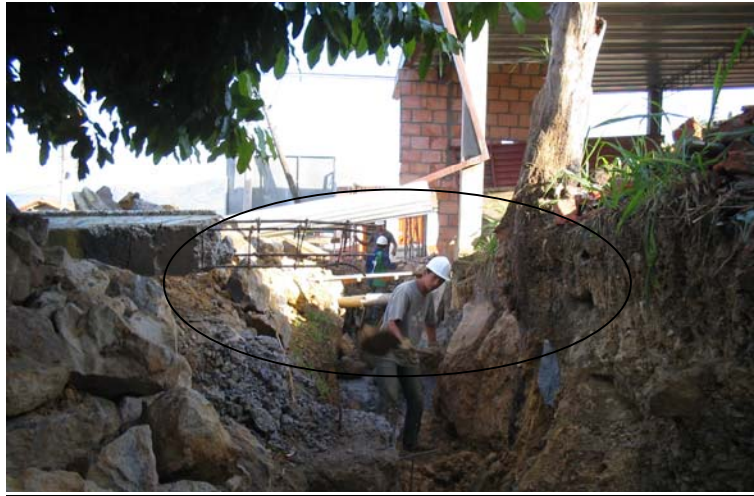
Fotografía 34. Columnas de concreto reforzado demolidas por la carrera.
