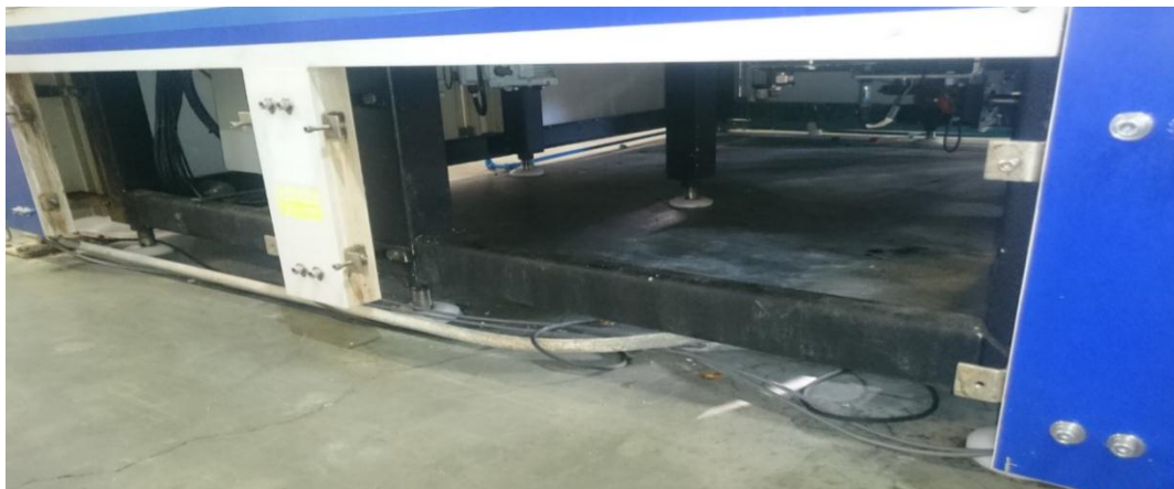
Figura 47. Retiro de foco de contaminación en la parte inferior del equipo
