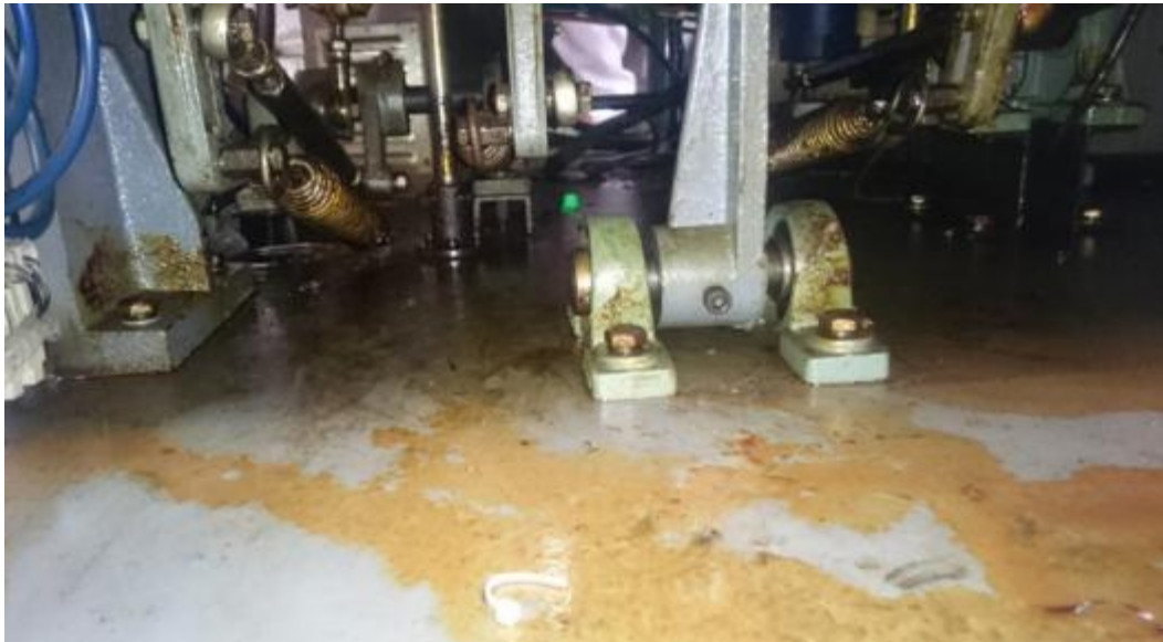
Figura 59. Fuga de aceite en el sistema motriz inferior
