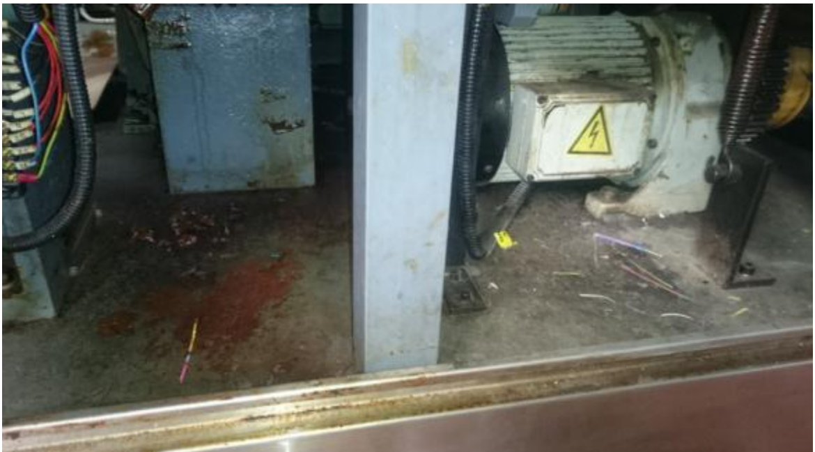
Figura 57. Contaminación detrás de las guardas
