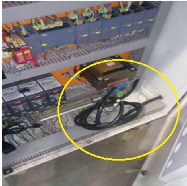
Figura 42. Cable excesivo, evitando cierre tablero eléctrico.
