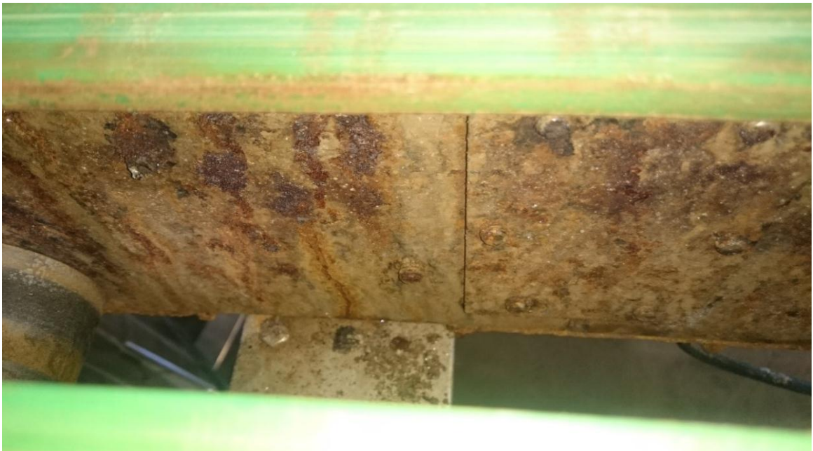
Figura 40. Guías de bandas con avanzado estado de oxidación.
