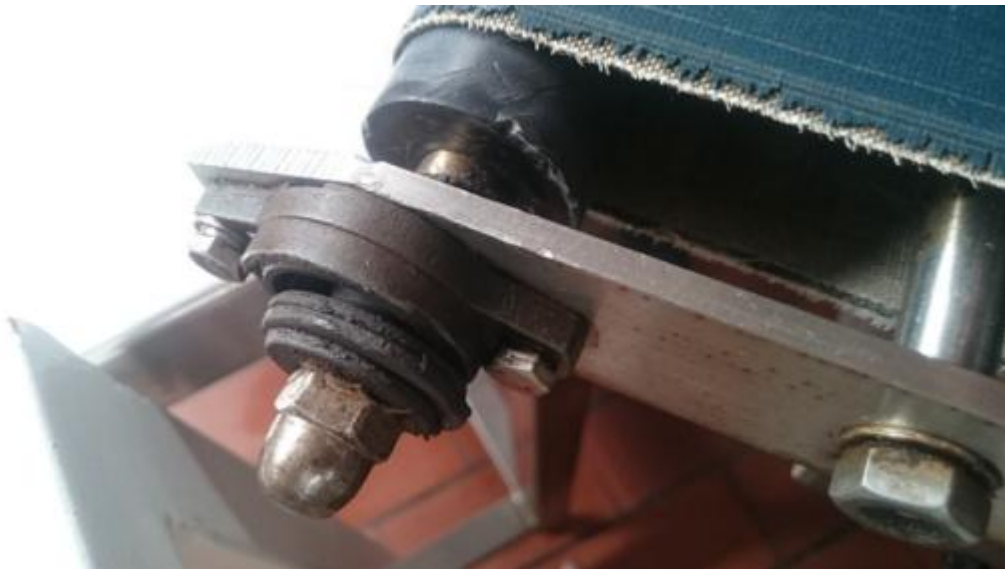
Figura 63. Banda funcionando con chumacera dañada
