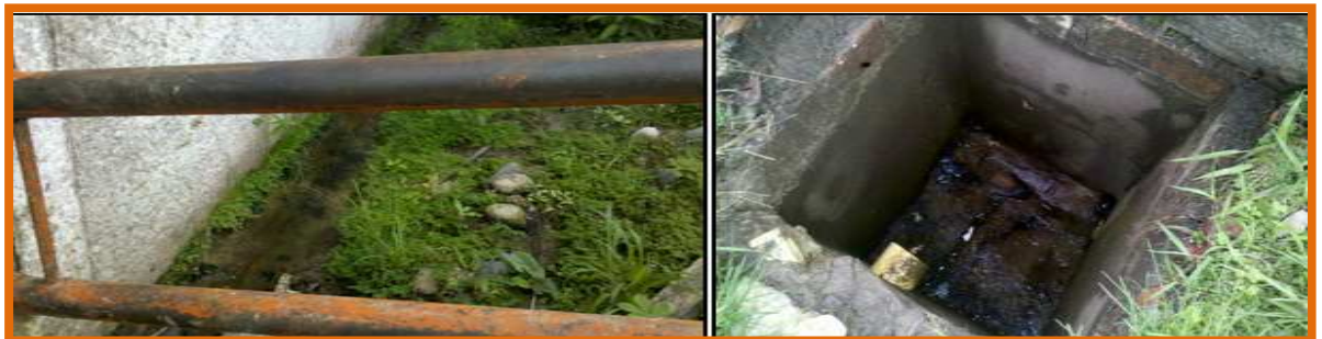
Fotografía No. 18 Cunetas y cajas de recolección e inspección
