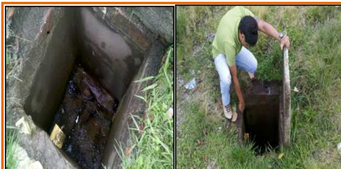
Fotografía No. 14 Trampa de grasas.
