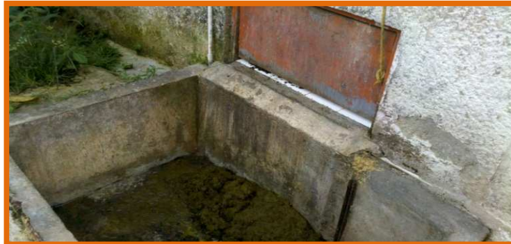
Fotografía No. 13 Tanque de decantación.
