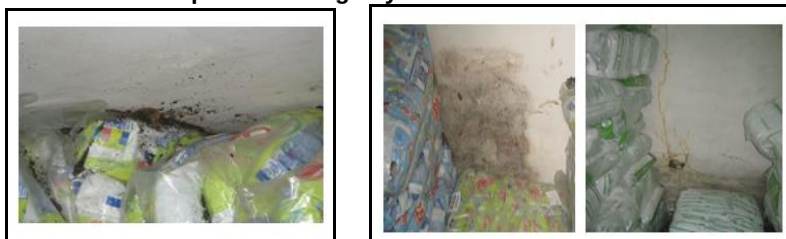
Imagen 5. Área afectada por murciélagos y condiciones de humedad
