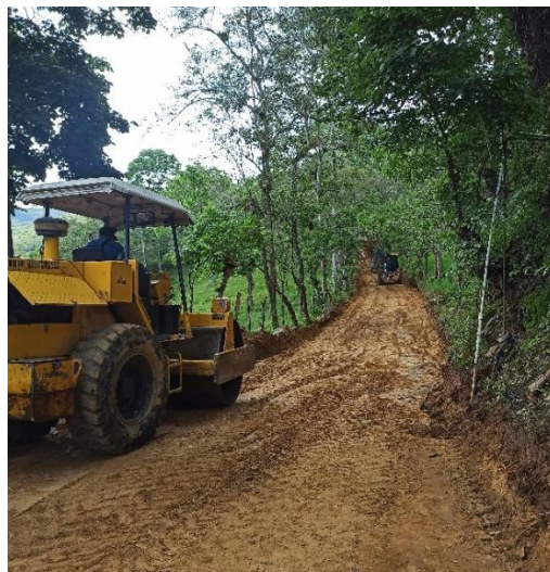
Figura 8. Compactación de subrasante en la vereda el Tabor en San Gil, Santander (fuente propia)
