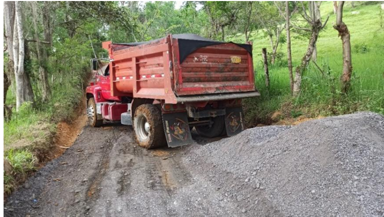
Figura 9. Vertimiento de subbase granular en la vereda el Tabor en San Gil, Santander.(fuente propia)
