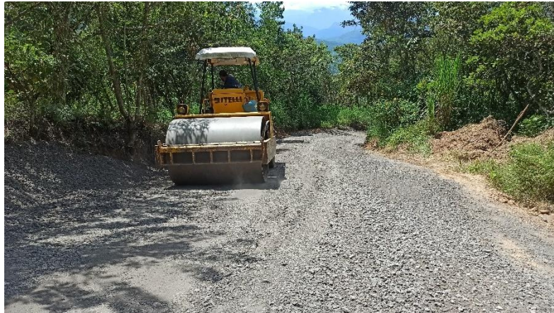
Figura 10. compactación de subbase granular en la vereda Benjaranas alto en el municipio de San Gil, Santander.(fuente propia)
