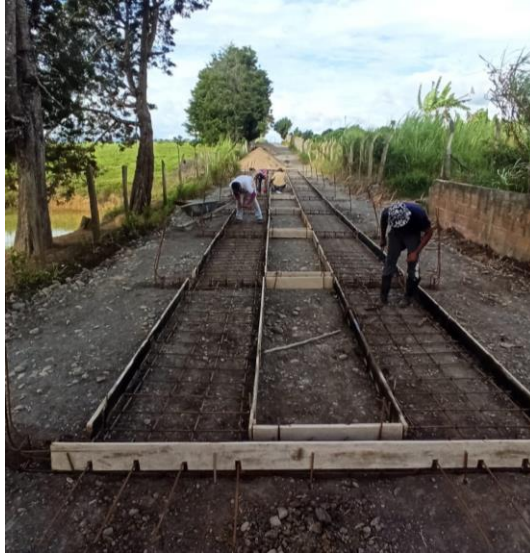
Figura 11. armado de acero de huellas y vigas riostras en la vereda los pozos en el municipio de San Gil, Santander.(fuente propia)
