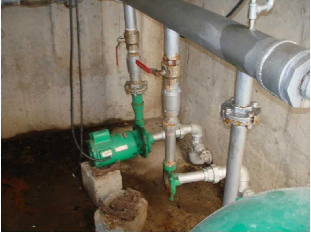
Figura 19. Ubicación de Motobombas
