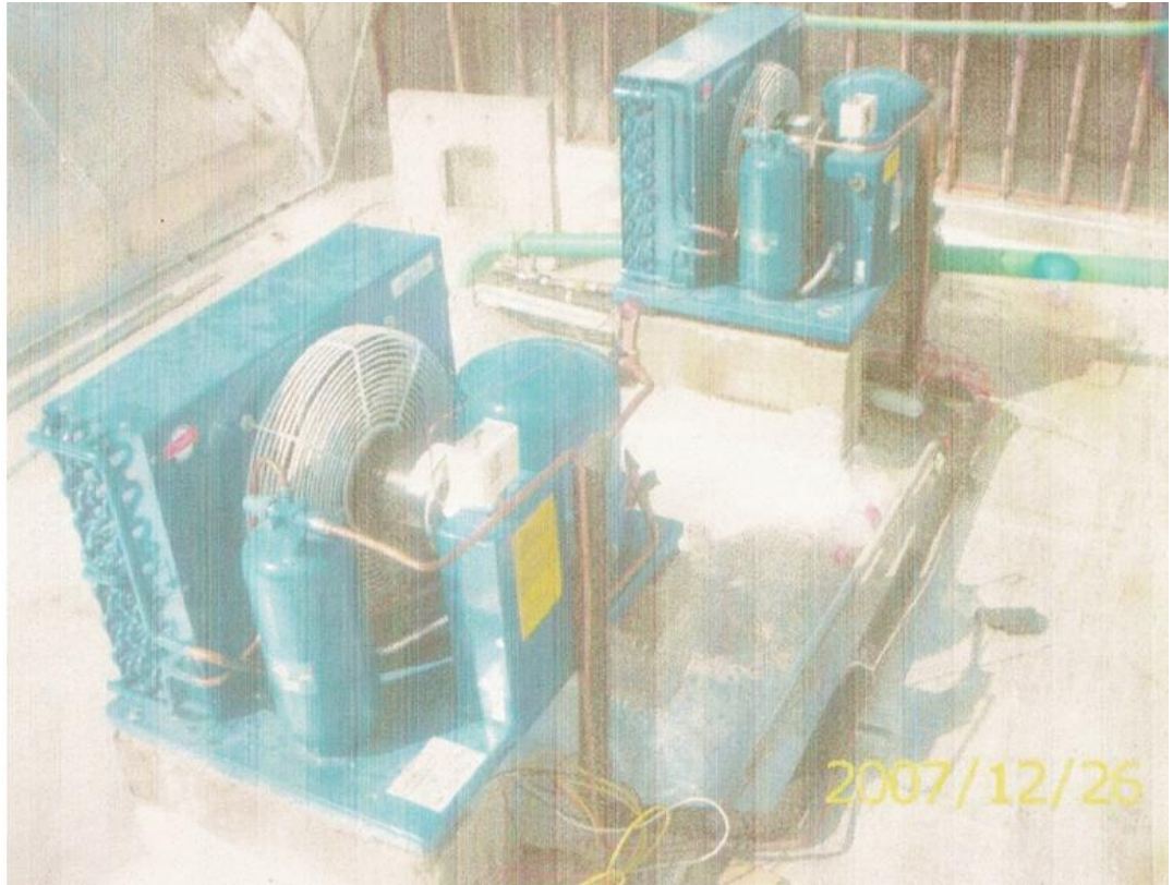
Figura 23. Unidades de enfriamiento
