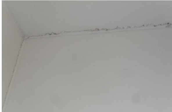
Figura 40. Agrietamiento en pared y techo.
