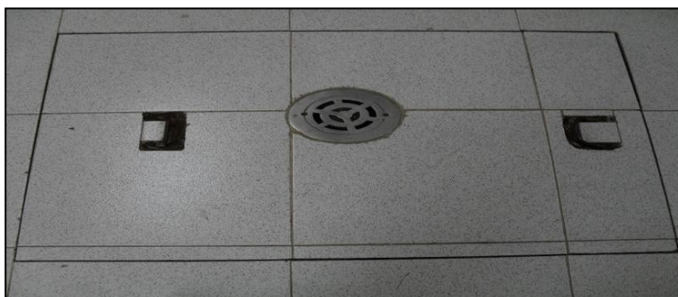
Figura 39. Manijas levantadas en vía de evacuación
