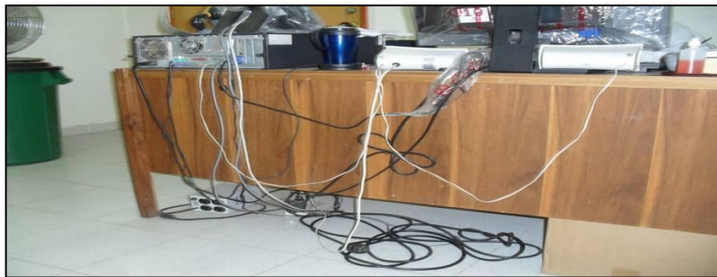
Figura 41. Cableado expuesto en el laboratorio
