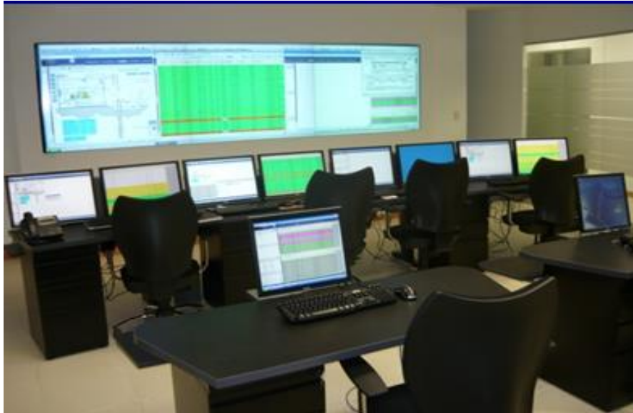
Figura 3, Centro de monitoreo remoto o cuarto de control
