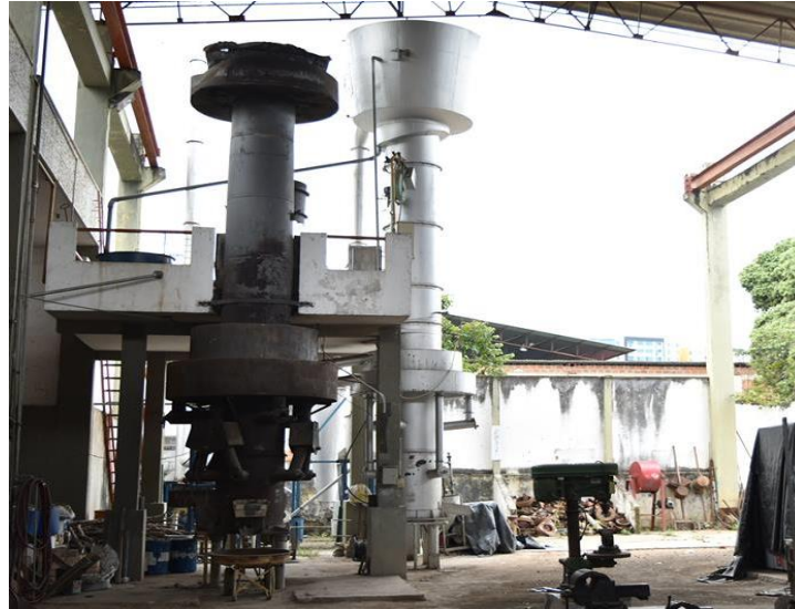
Figura 4. Horno cubilote ubicado en planta de aceros.
