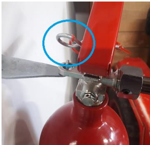
Figura 3. Pasador de seguridad del extintor.
