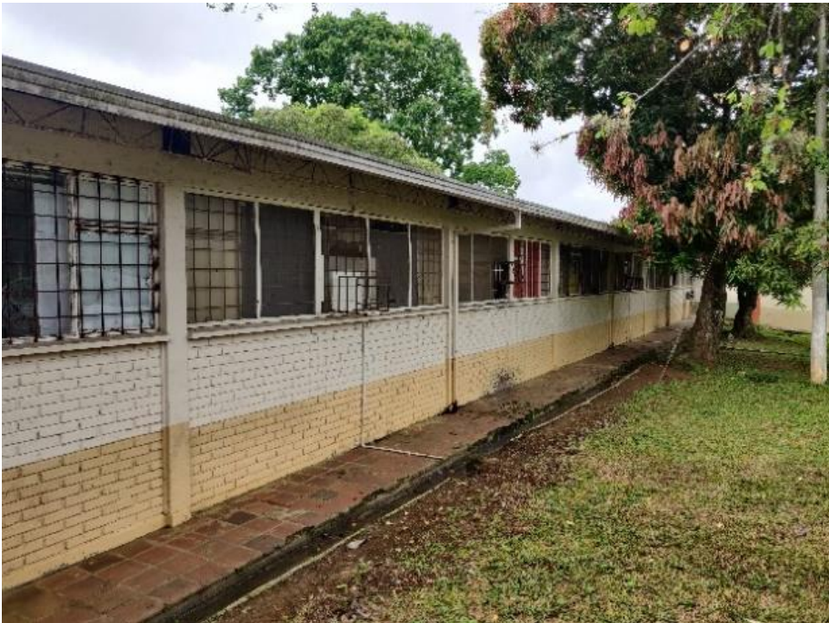
Figura 2. Problema de seguridad por falta ventanas de seguridad en las habitaciones.
