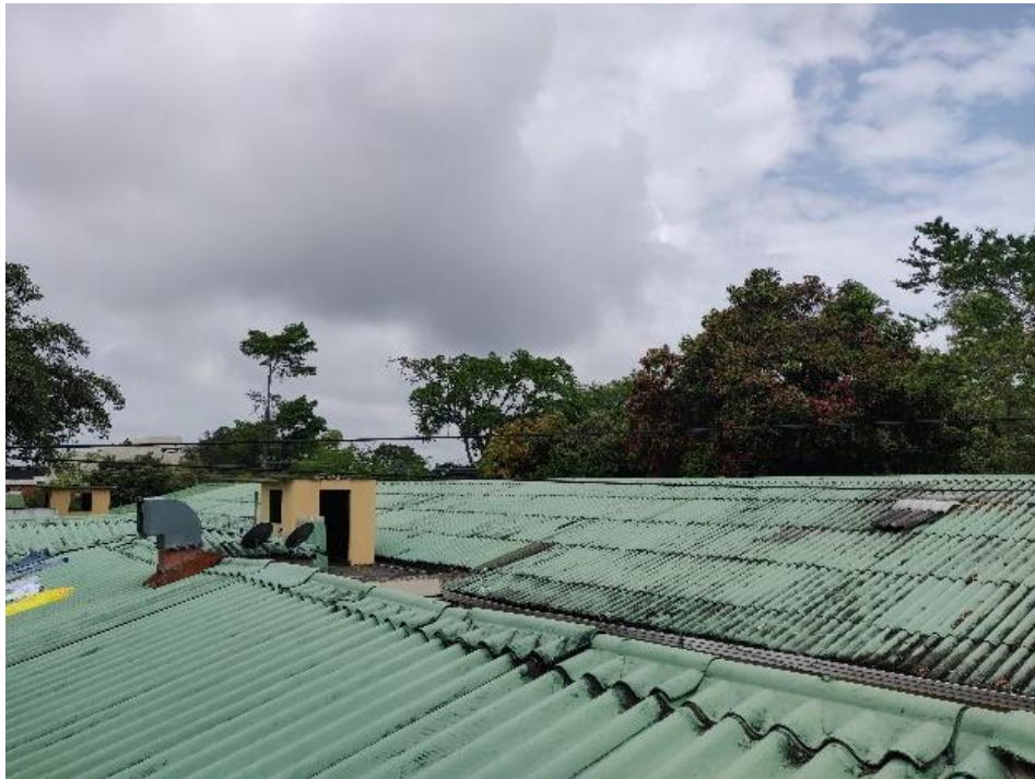
Figura 4. La cubierta sobre el sector de las habitaciones presentaba tejas rotas y corridas.
