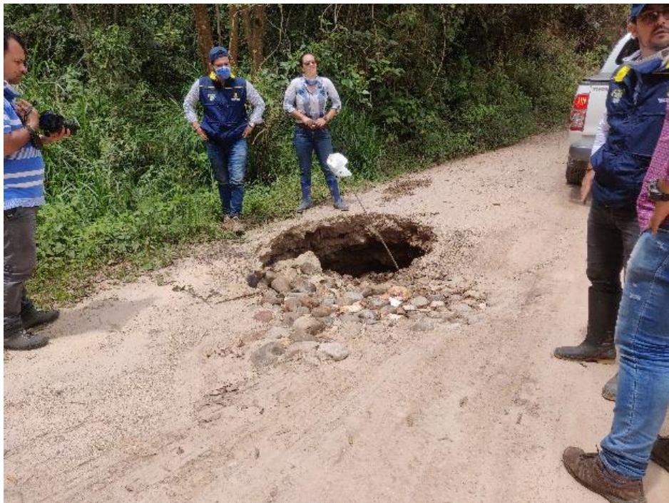
Figura 12. En un sector de la vía se encontró un enorme hueco el cual afectaba un 40% del ancho de la vía.
