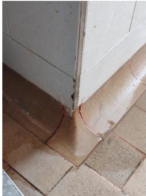
Figura 6. Los remates del enchape de pared y piso no correspondían a los de un enchape nuevo.
