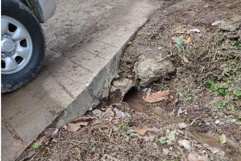
Figura 9. Uno de los principales problemas era el manejo de las aguas de escorrentía debido a la falta de obras de arte y al taponamiento de las existentes.
