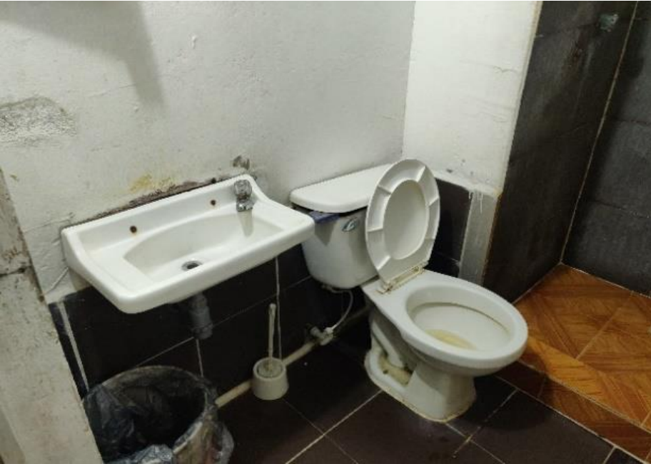
Figura 3. Instalaciones y aparatos sanitarios dañados, requieren cambio.
