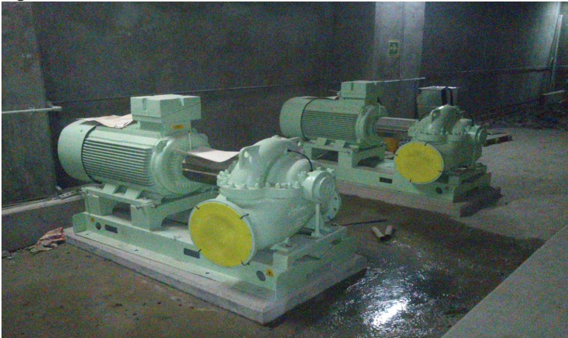
Figura 20. Bombas de circuito cerrado.
