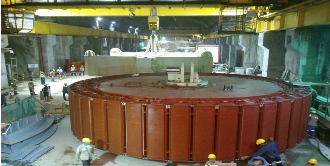
Figura 6. Rotor Del generador En Caverna de Maquinas El. 163,40
