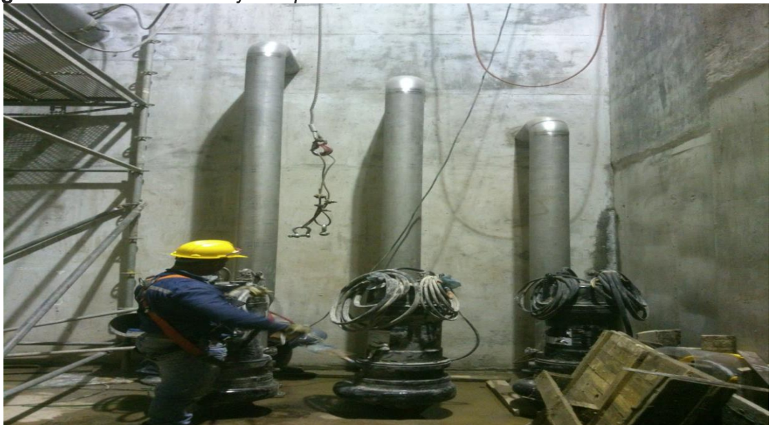
Figura 28. Bombas Drenaje En pozo Sentina.
