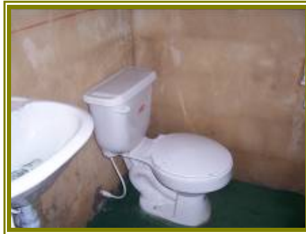
Imagen 25 Combo Sanitario Unidad Sanitaria Puente Nacional
