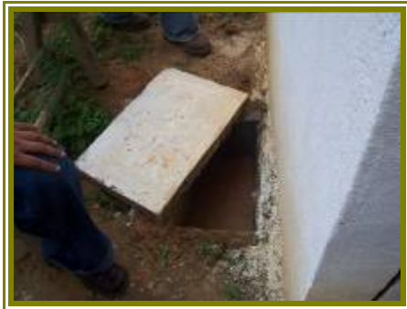
Imagen 13 Tanque Unidad Sanitaria Matanza
