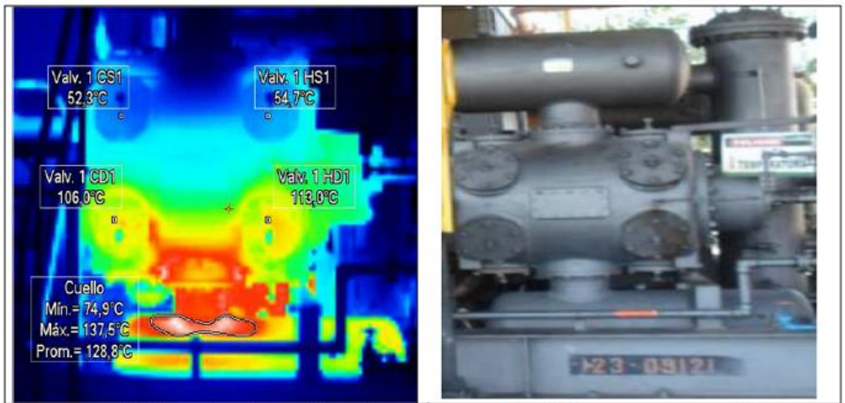
Figura 4. Termo grama en válvulas de cilindro compresor #1
