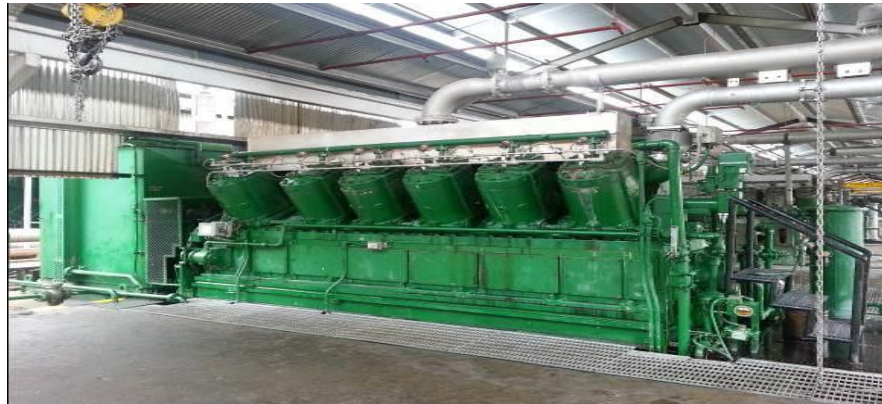
Figura 20. Unidad Compresora de Baja Presión IR 12SVG
